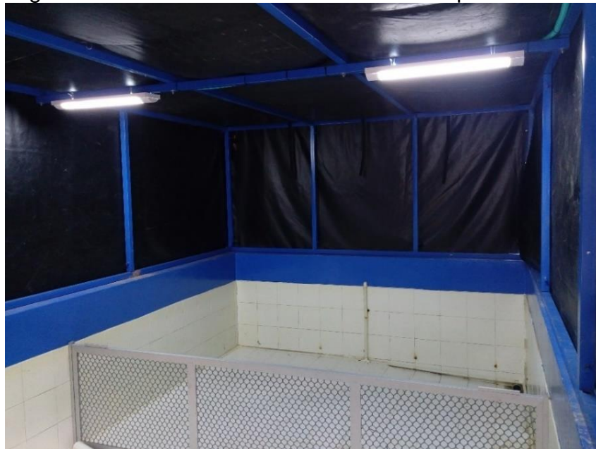
Figura 8. Fotografía sistema de iluminación de los estanques.
