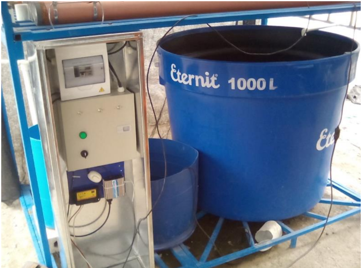
Figura 28. Cajón eléctrico del sistema de acuaponía SA50-2014
