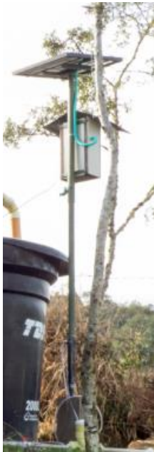
Figura 26. Estructura de instalación (estación C)
