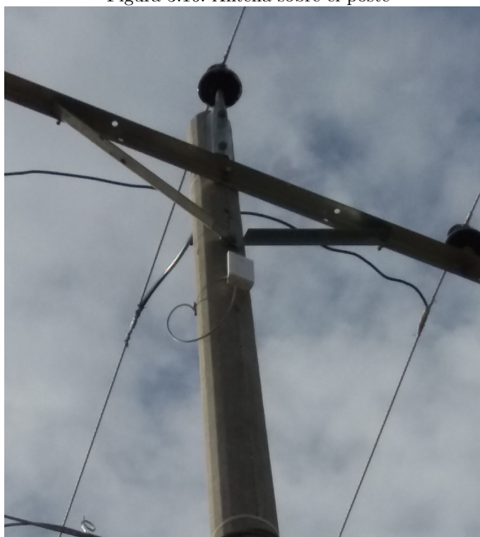
Figura 3.16: Antena sobre el poste
