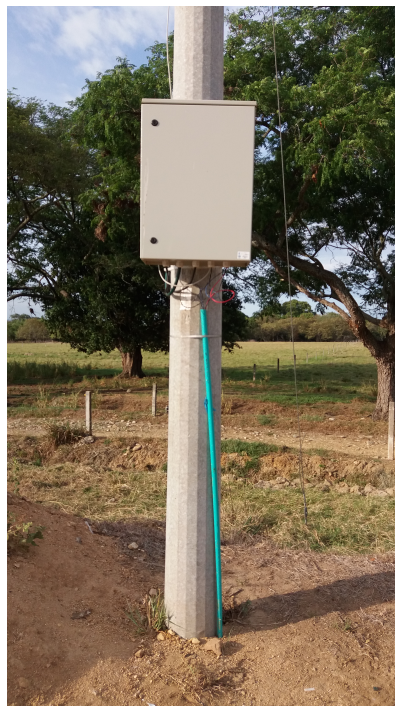
Figura 3.26: Caja sobre el poste
