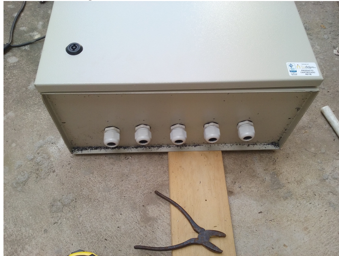
Figura 3.23: Entradas del cableado
