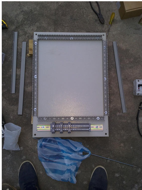
Figura 3.24: Bornes eléctricos y canaleta
