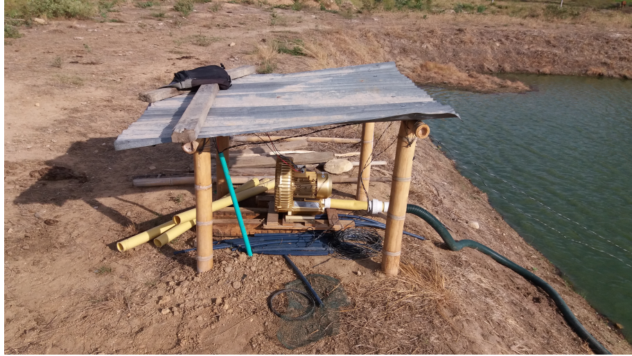
Figura 3.19: Blower en la caseta
