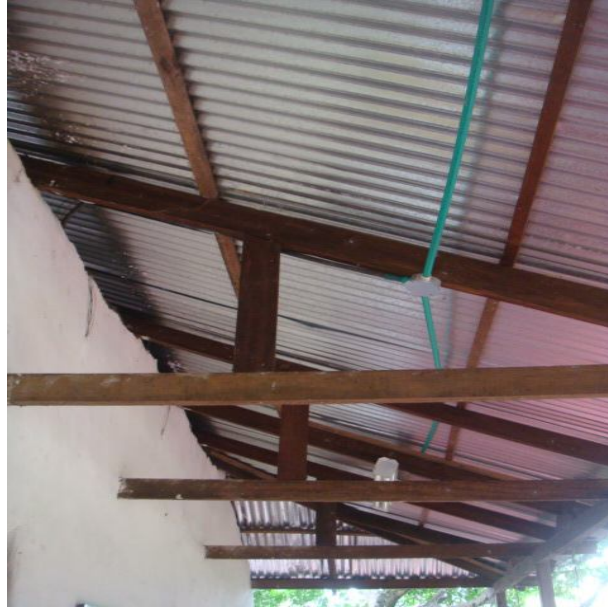
Foto 32. Circuito eléctrico debidamente instalado al interior de la casa
