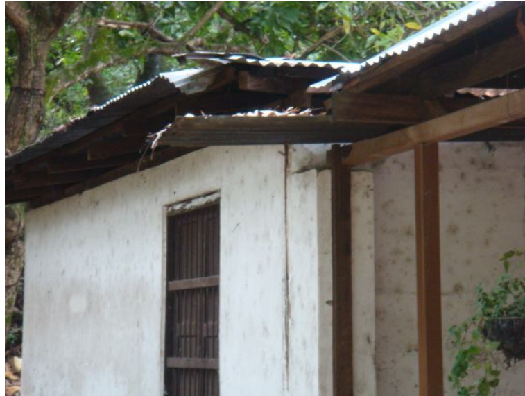
Foto 10. Daños en la estructura parte lateral izquierda
