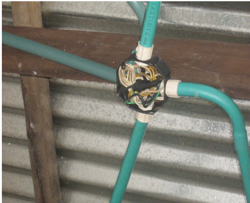
Foto 31. Circuito eléctrico con cables expuestos en el techo
