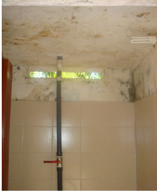
Foto 16. Humedad parte interior baños
