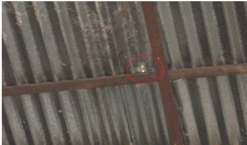
Foto 22. Goteras en el techo de la casa
