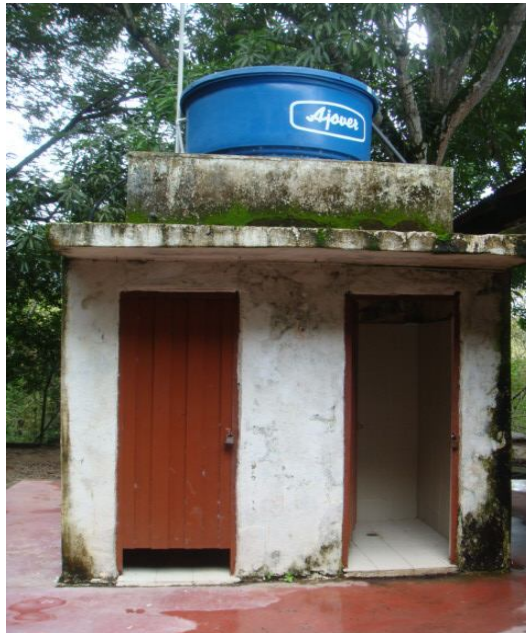
Foto 15. Humedad parte frontal baños
