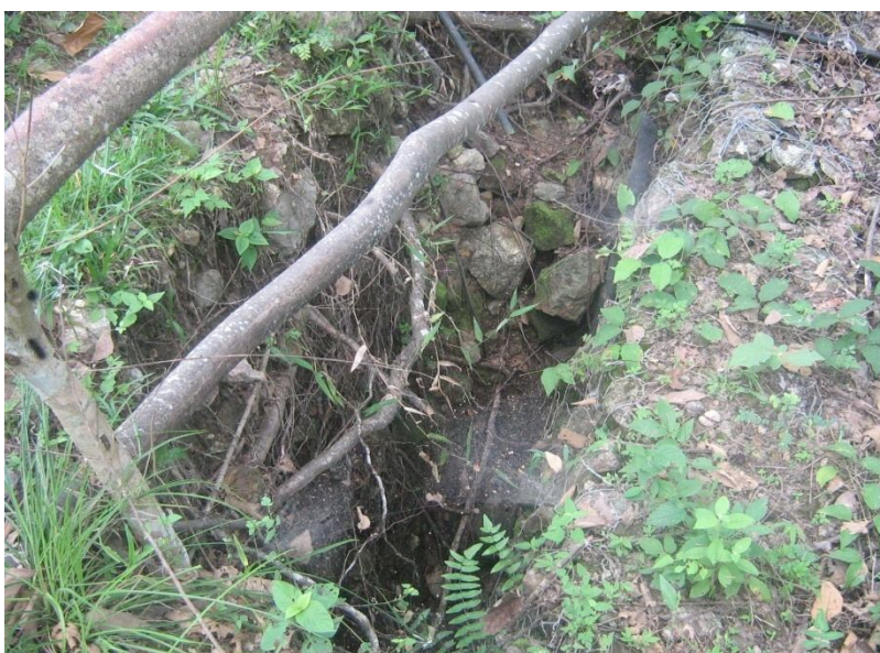
Foto 80. Gavión en mal estado
