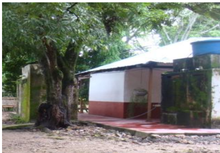
Foto 13. Humedad parte posterior de los baños
