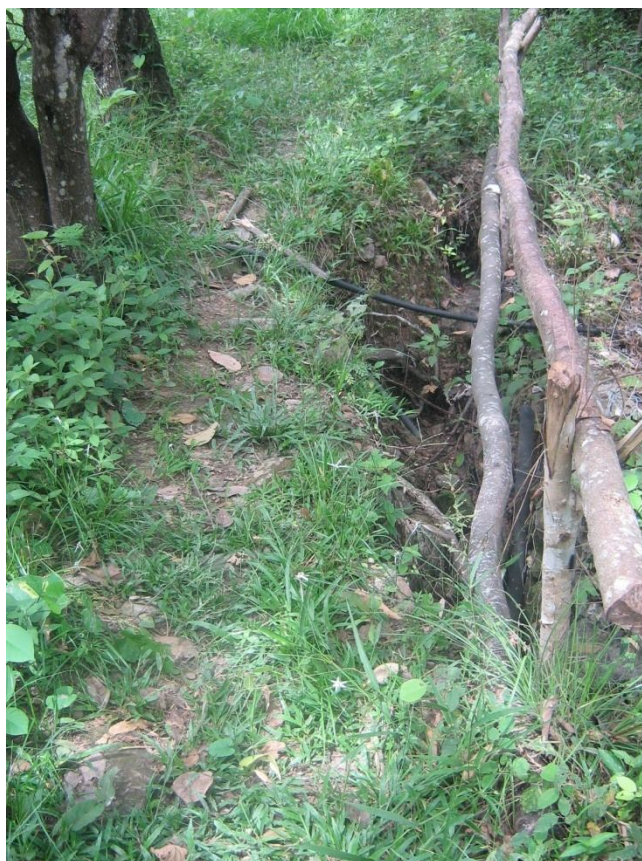
Foto 81. Gavión en mal estado está dañando el sendero
