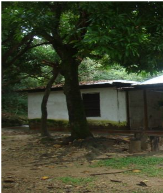
Foto 12. Humedad parte posterior almacén y cocina
