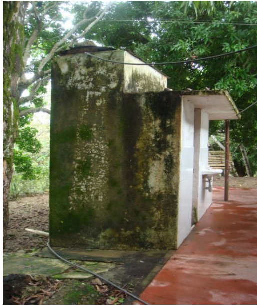
Foto 14. Humedad parte lateral baños
