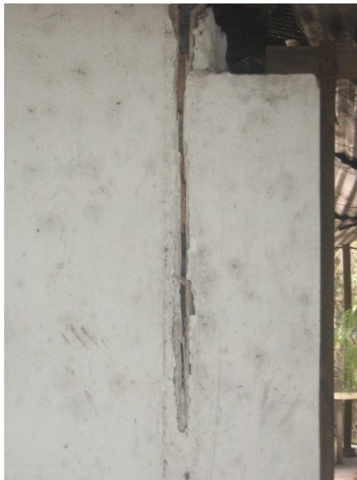
Foto 11. Daños en la estructura parte lateral izquierda
