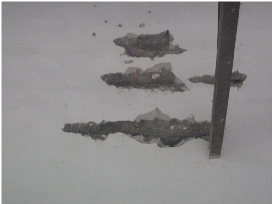
Foto 9. Daños en la estructura frente de la casa
