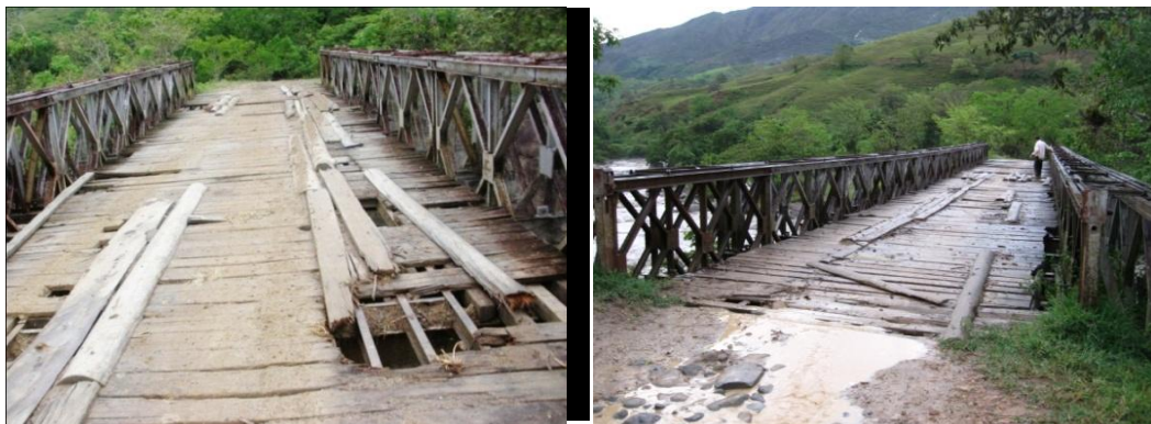
Imagen n°:37 En la imagen se puede observar el mal estado del puente sobre el río Cabrera, el cual es acceso a la región abarcada por el Centro Poblado Santa Ana y las veredas vecinas.
