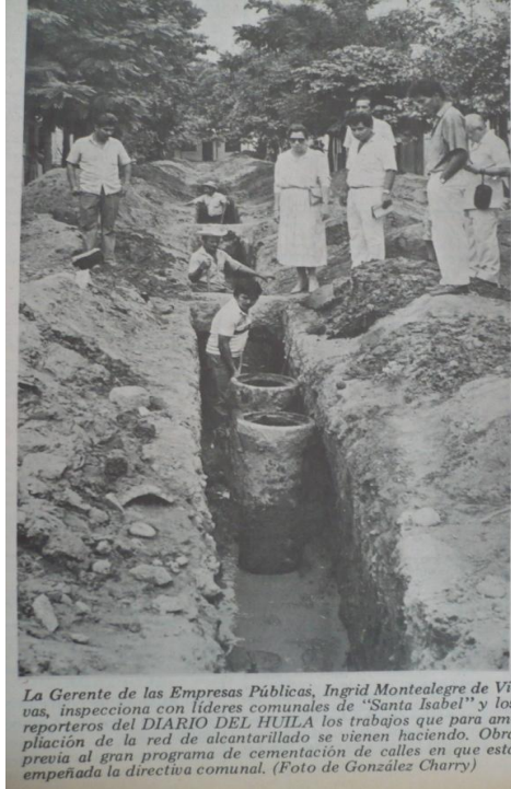
A ritmo acelerado avanzan los trabajos de sustitución de tubería en el alcantarillado de "Santa Isabel". Detrás de esta obra vendrá la cementación de las vías, conforme al ambicioso plan de trabajo que se trazó la directiva comunal presidida por Víctor Julio Medina. (Foto de González Charry)
