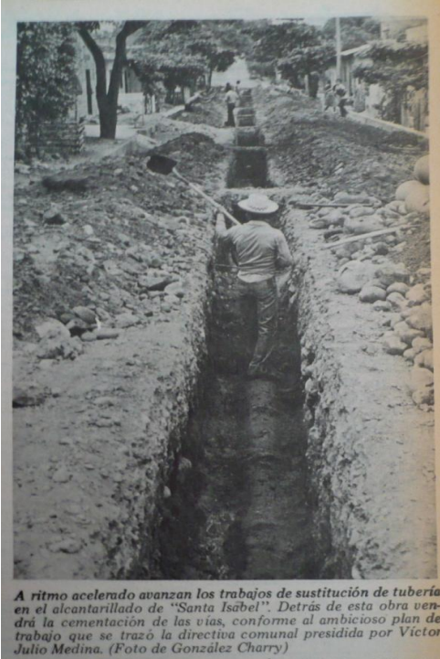
Foto 7. Alcantarillado de Santa Isabel.
