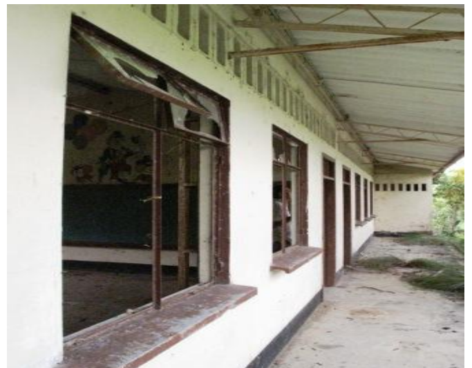
IMAGEN 28. Complementa la anterior, se encuentra deteriorada y abandonada.
