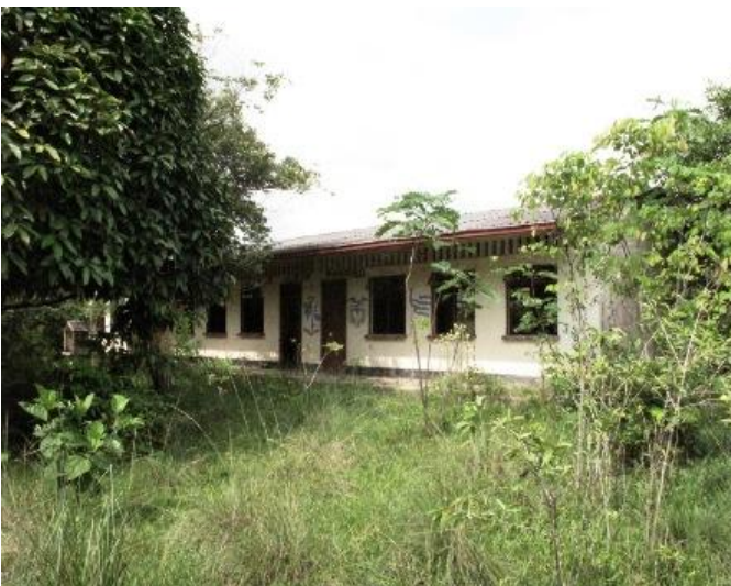
IMAGEN 27. Escuela Nuevo Paraíso, km. 17, desabitada.
