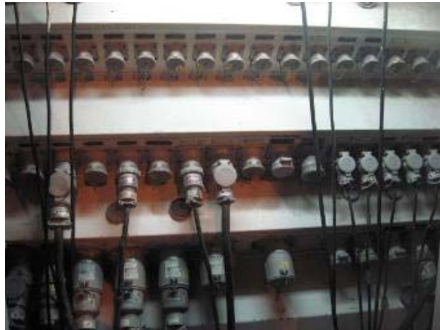
Figura 31. Conexiones eléctricas a prueba de explosión
