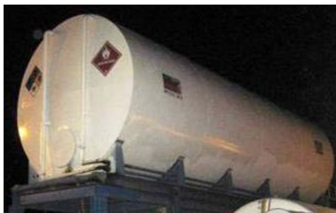
Figura 37. Tanques de ACPM
