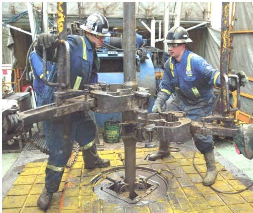
Figura 5.3. Cuñeros colocando las llaves de potencia para torquear una conexión. La llave derecha se ubica en el tubo superior y la llave izquierda en el tubo inferior. Es necesario tener en cuenta que esta operación únicamente debe realizarse con la tubería asentada en las cuñas, para que no esté sometida a tensión durante este proceso (tomada de worldoil.com)
