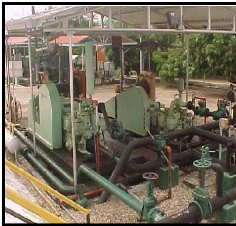
Figura 10. Bombas de Transferencia.
