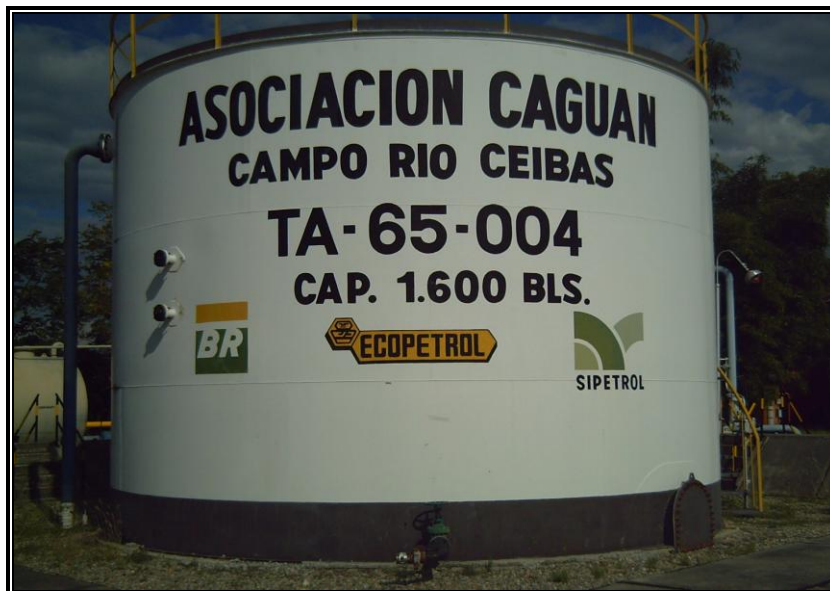
Foto 4. Tanque de agua clarificada (TA 65–004)
