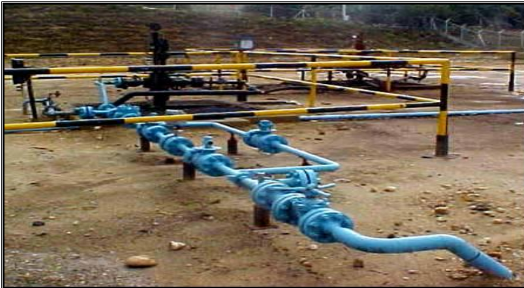
Foto 10. Pozo inyector de agua
