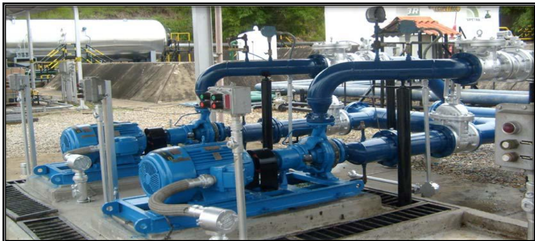
Foto 2. Bombas de transferencia (P-65-003A/B).
