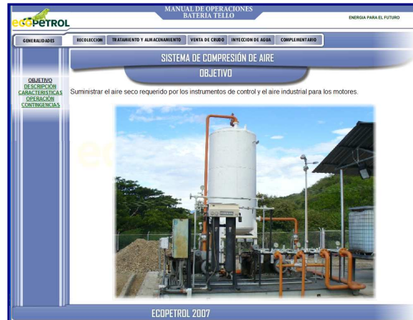
Figura 48. Ventana de objetivo del sistema de compresión de aire del menú de tratamiento y almacenamiento
