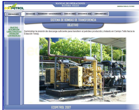
Figura 72. Ventana de objetivo del sistema de bombas de transferencia del menú de venta de crudo
