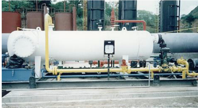
Figura 6. Vista general de un separador
