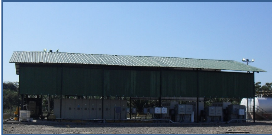
Foto 12.1. Área Generación Plataforma D
