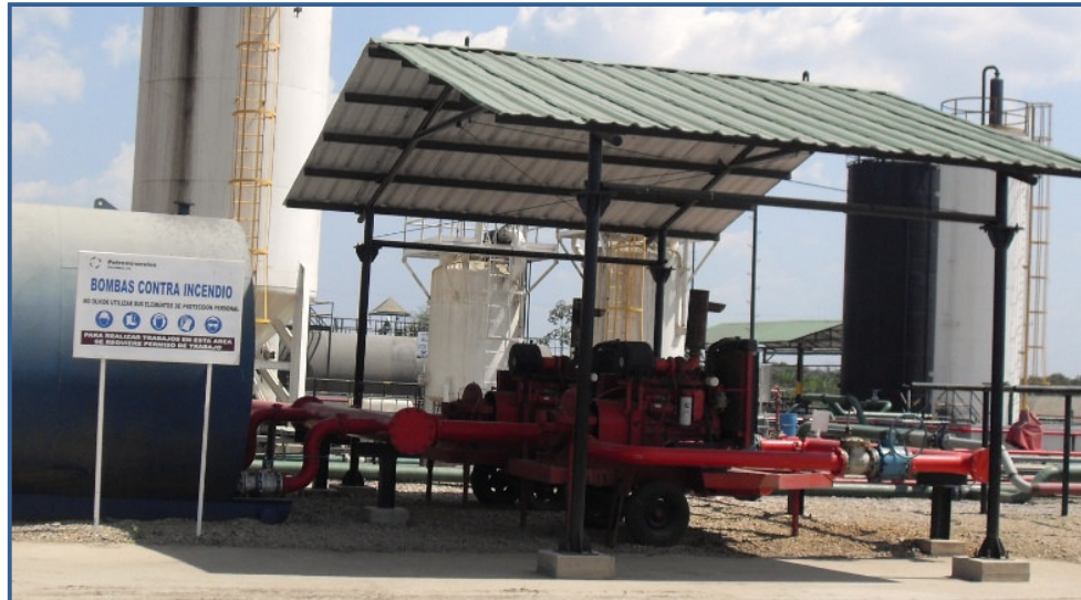
Foto11.1. Sistema Contra Incendio
