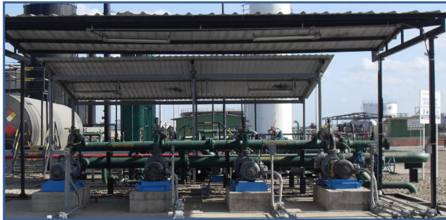
Foto 7.2. Bombas de Transferencia de Agua
