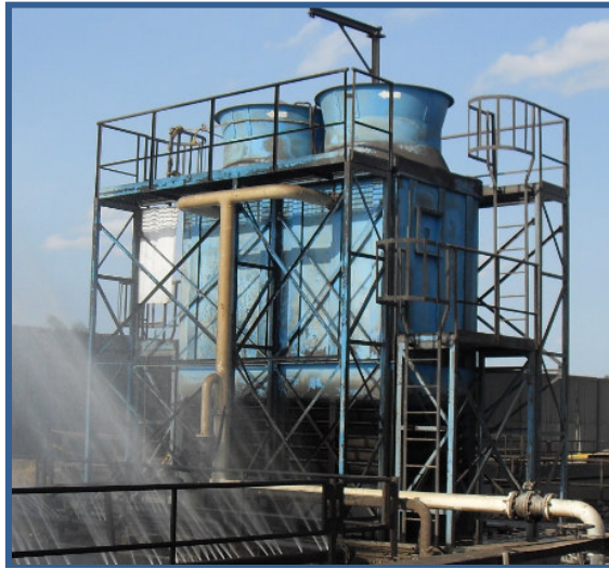
Foto. 7.4. Torre de Aireación.
