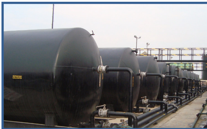
Foto 6.2. Tanques Almacenamiento de 500 Bls
