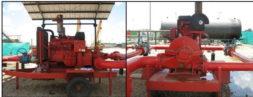
Foto 11.3. Bombas de Agua Contra Incendio
