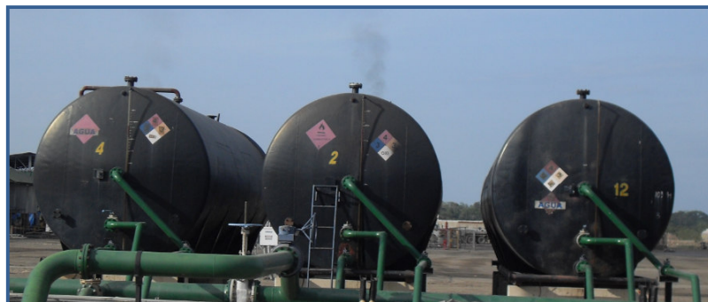
Foto. 7.7. Tanques de Almacenamiento de agua.
