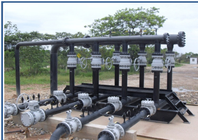
Foto 2.3. Manifold Locación C
