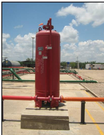
Foto 11.5. Tanque de Vejiga
