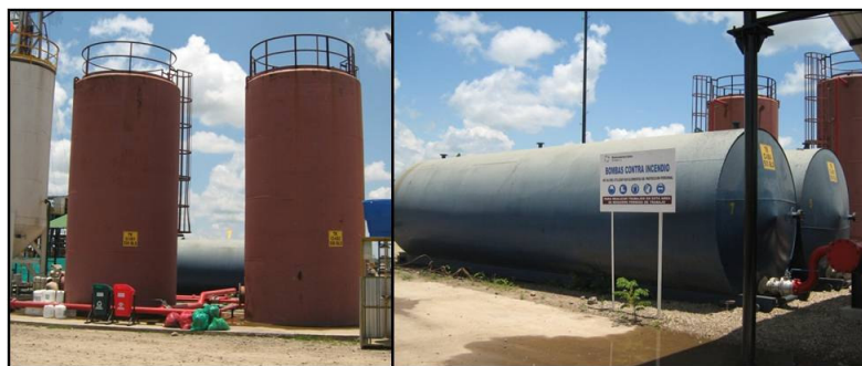
Foto 11.2. Tanques de Almacenamiento de Agua
