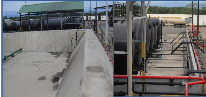
Foto 9.1. Cárcamo Perimetral y Cajilla Recolectora.
