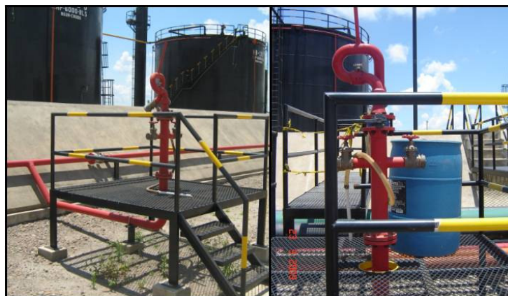
Foto 11.7. Hidrantes Monitores de Agua-Espuma
