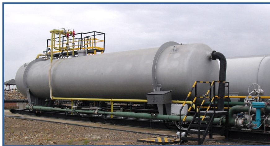
Foto 4.3. Separador de prueba
