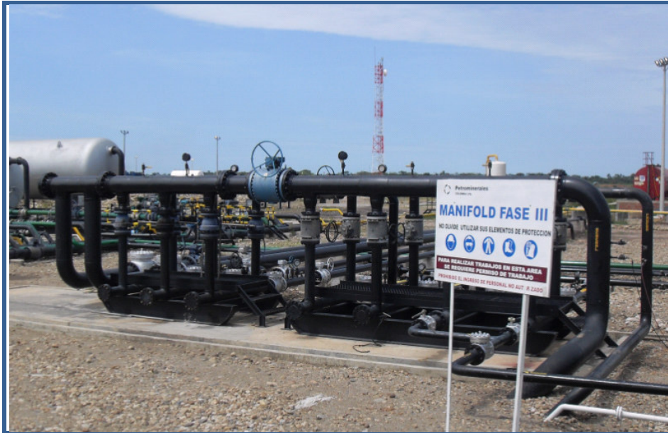
Foto 2.1. Colector General y Prueba Locación A
