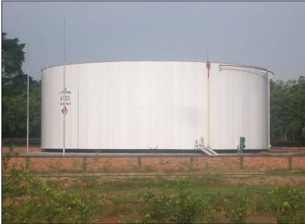
Figura 38. Tanque de Almacenamiento.
