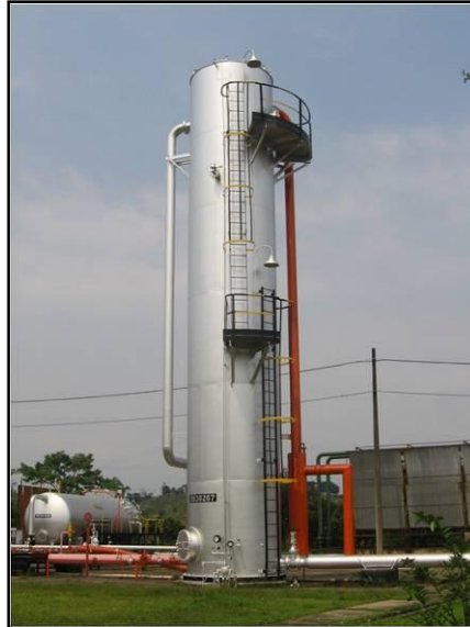
Figura 31. Separador de vertical de Tercera Etapa
