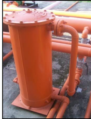
Figura 53. Secador de gas combustible para moto-compresores
