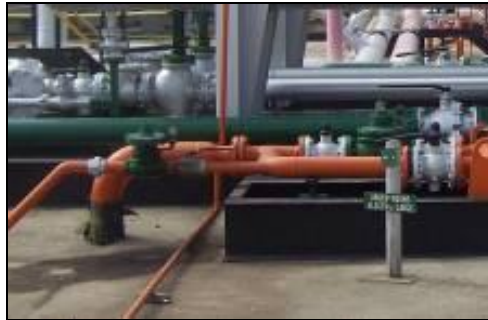
Figura 33. Válvula reguladora de presión en línea de gas de los separadores generales.
