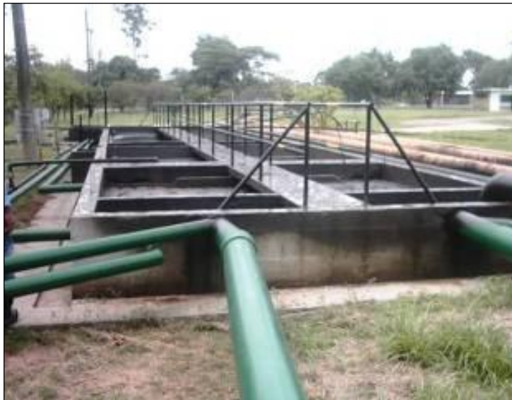
Figura 77. Cámaras de Residencia y Sumidero respectivamente.
