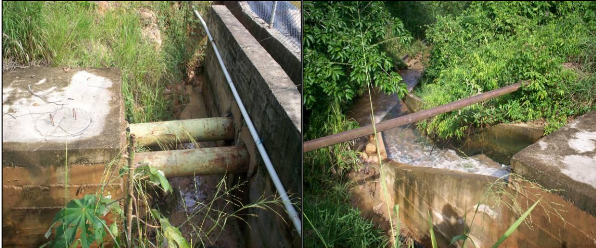
Figura 80. Caja de Recibo y Canal de Descarga respectivamente.
