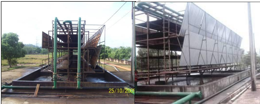
Figura 74. Torre de Enfriamiento.
