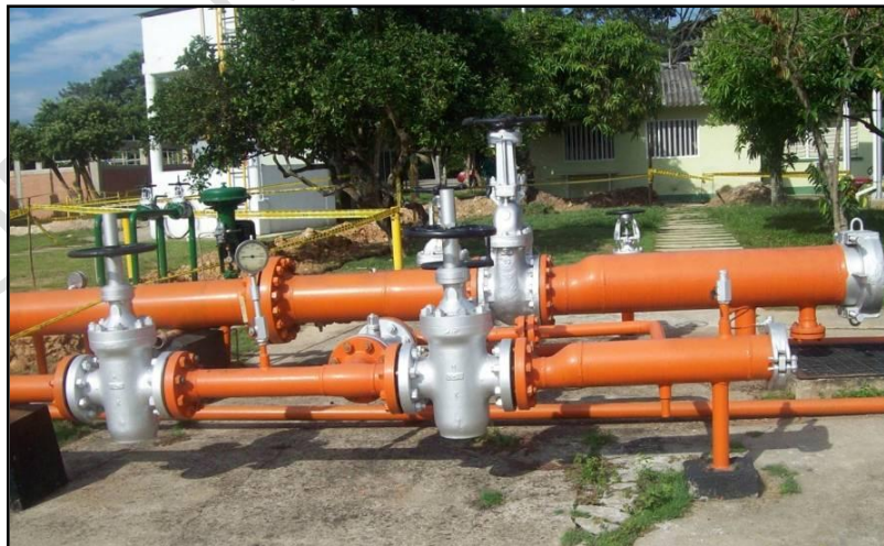
Figura 9. Válvulas de Compuerta en línea de llegada de gas GS-2.
