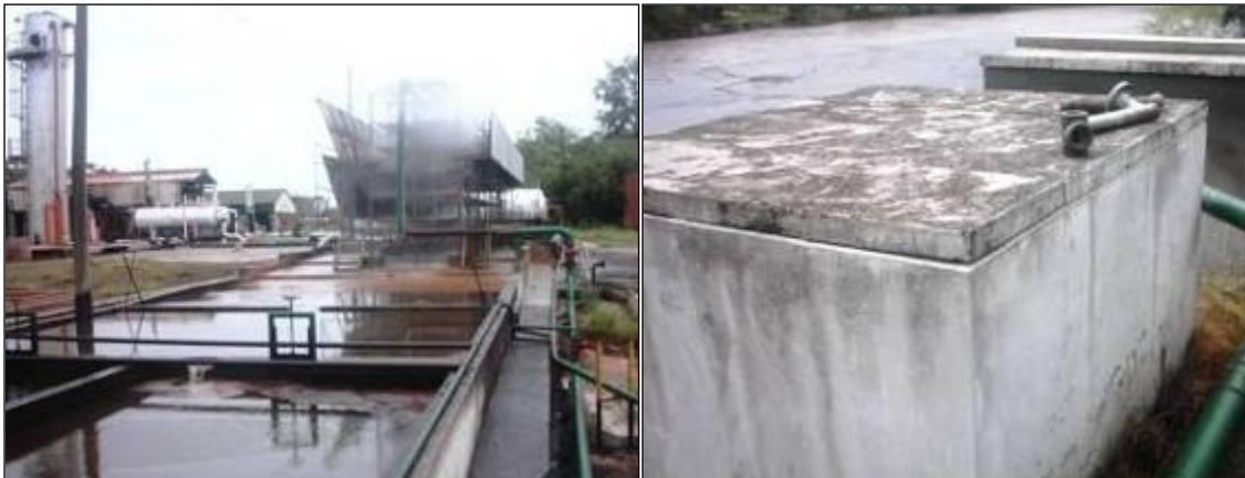
Figura 76. Cámaras de Residencia y Sumidero respectivamente.
