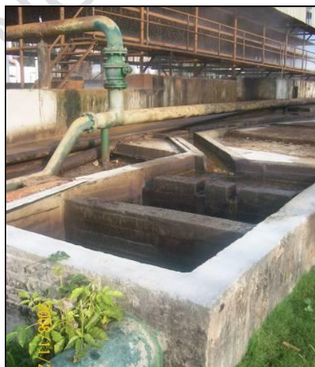
Figura 67. Caja de Drenaje de torre de enfriamiento.
