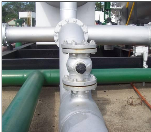
Figura 10. Válvula de Bola en línea de Crudo del Separador.
