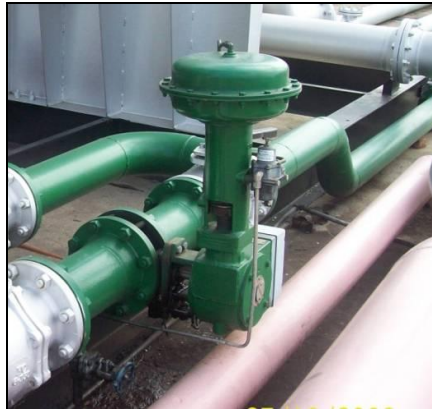
Figura 12. Válvula Automática Reguladora del Nivel de agua en el separador.
