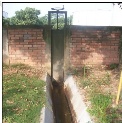
Figura 69. Compuertas de comunicación entre los patios de tanques.
