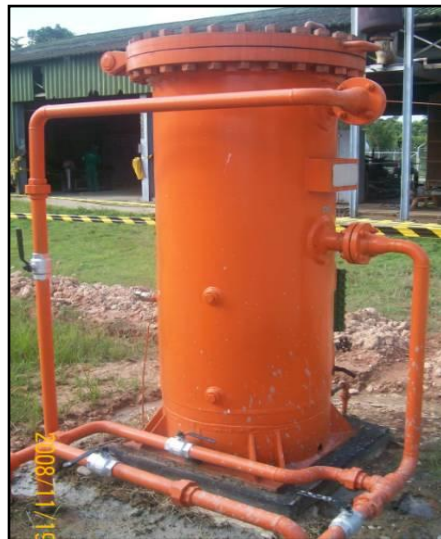
Figura 55. Secador de gas combustible de bombas de transferencia y generadores
