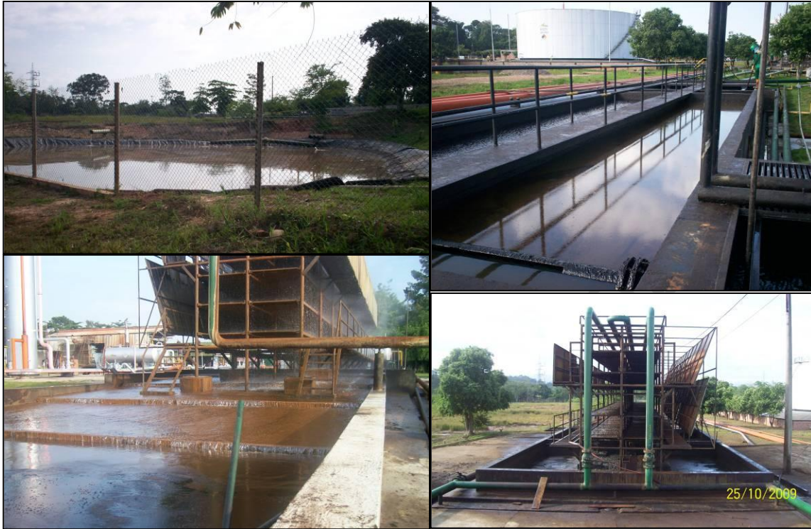
Figura 73. Sistema de Tratamiento de Agua.
