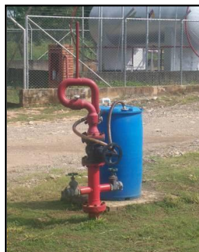
Figura 85. Hidrante con tanque almacenador de químico
