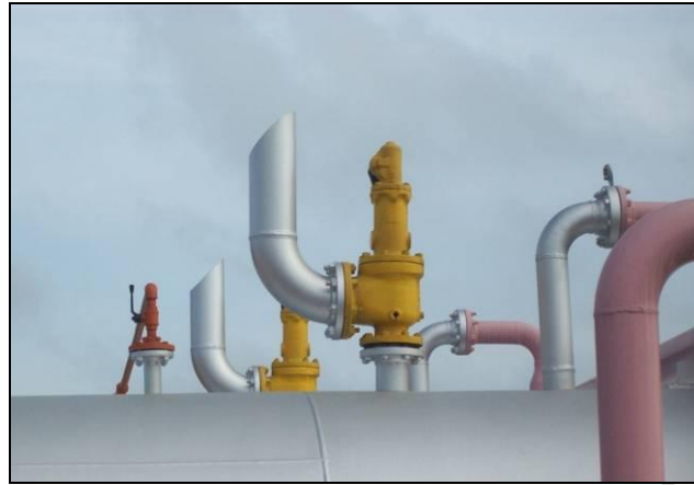
Figura 15. Válvula de seguridad de resorte de los separadores
