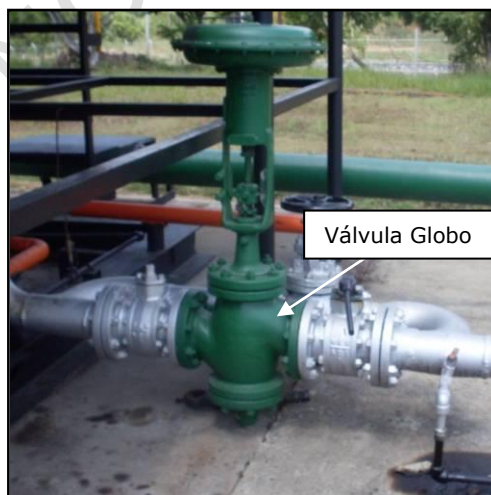
Figura 13. Válvula de globo en línea de salida de Crudo del separador.
