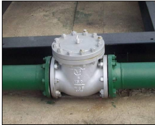
Figura 14. Válvula de Retención o Check en línea de salida de agua.
