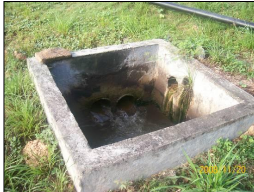
Figura 68. Caja de Drenaje del costado oeste de la torre de enfriamiento.
