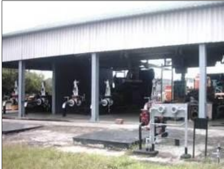
Figura 45. Caseta de Bombas de Transferencia.
