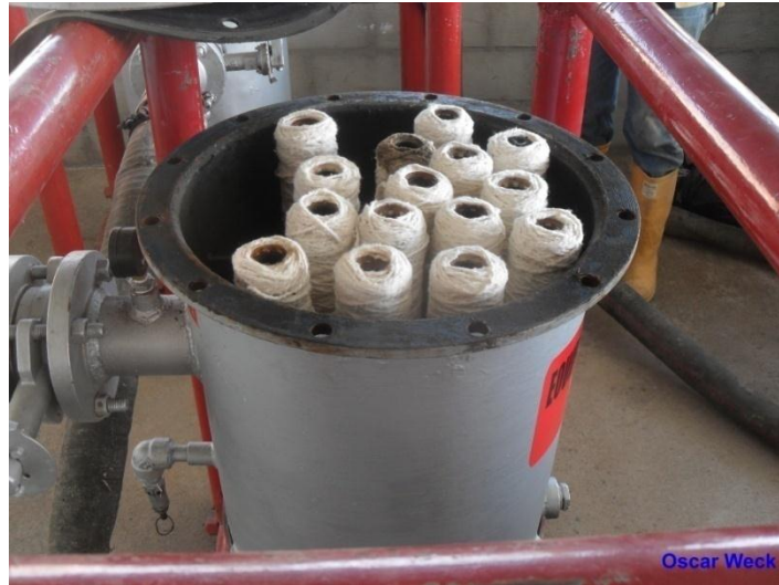
Figura 14. Interior unidad de filtrado
