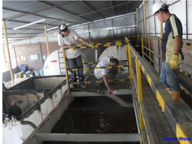
Figura 16. Tanques de almacenamiento
