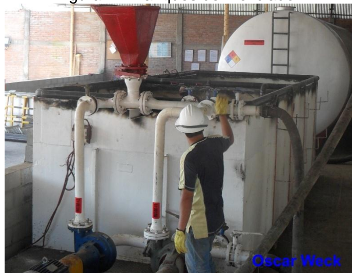
Figura 17. Tanques de mezclado
