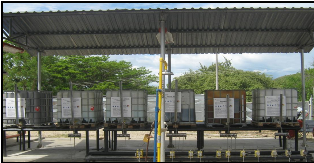
Figura 3. SISTEMA DE INYECCIÓN DE QUÍMICOS
