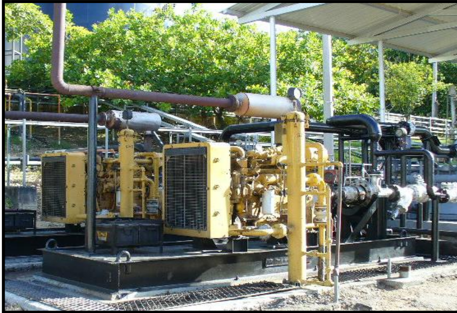
Figura 9. BOMBAS DE TRANSFERENCIA DE CRUDO
