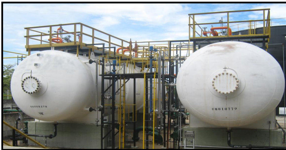
Figura 5. SEPARADORES TRIFÁSICOS T-SP-304 Y T-SP-305
