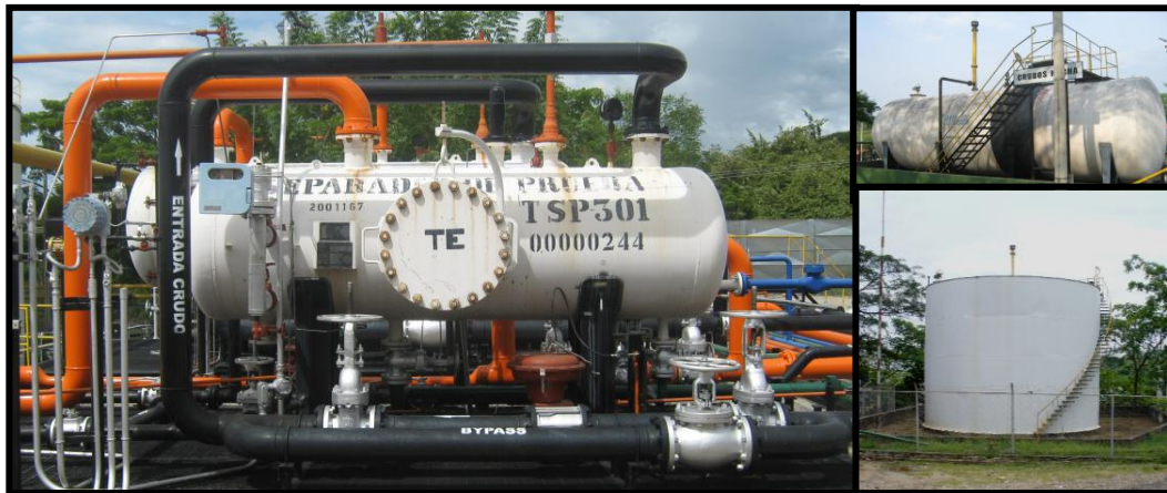
Figura 6. SEPARADOR DE PRUEBA Y TANQUES DE PRUEBA
