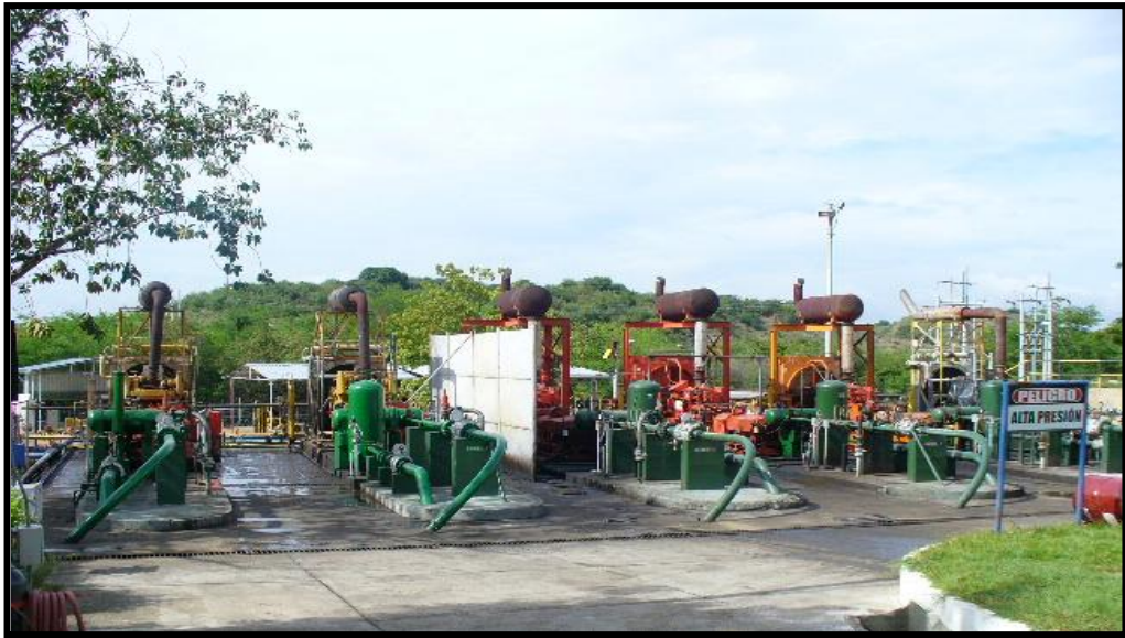
Figura 12. BOMBAS DE INYECCIÓN DE AGUA
