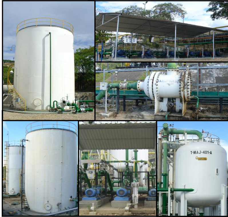
Figura 11. TANQUE DESNATADOR, BOMBAS AURORAS, HIDROCICLÓN, TANQUES DE AGUA A FILTRACIÓN, BOMBAS DE FILTRACIÓN Y FILTROS US
