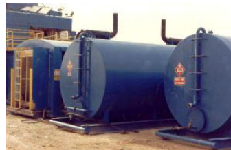
Figura 100. Tanque de combustible
