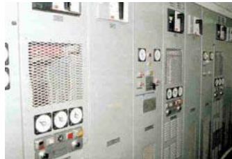
Figura 102. Mando de electricidad
