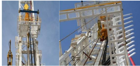
Figura 15. Encuelladero y sistema de levantamiento por cables
