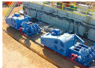
Figura 103. Bombas de lodo
