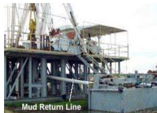
Figura 132. Línea de retorno de lodo
