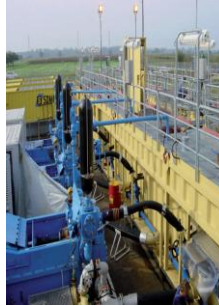
Figura 161. Líneas de retorno de lodo
