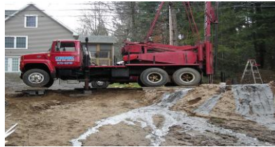
Figura 69. Equipo SpeedStar por cable usado en Ballston Spa, NY
