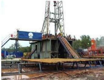
Figura 109. Plataforma de tubería
