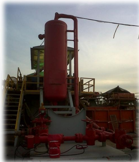
Figura 1.46 Separador de lodo y gas. (foto de poor boy de taladro Pioneer 51, campo Castilla Norte)
