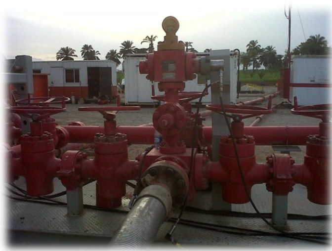
Figura 1.44 Válvulas de control de influjos (foto de Chock manifold de taladro Pioneer 51, campo Castilla Norte).
