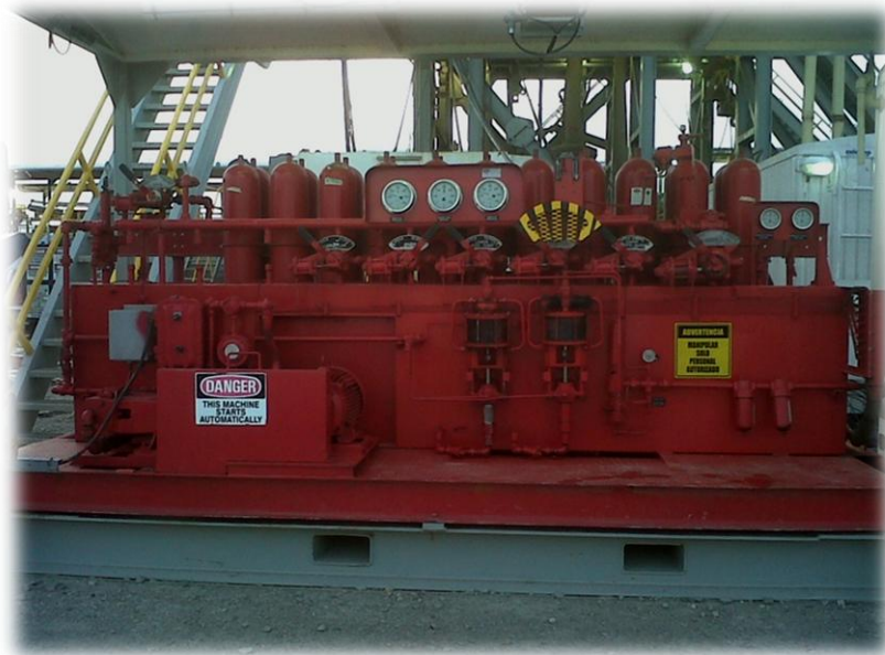
Figura 1.43 Banco de acumuladores. (foto de acumuladores de taladro Pioneer 51, campo Castilla Norte)
