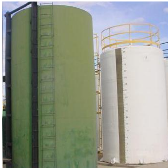
Figura 3. Tanques cilíndricos verticales 4
