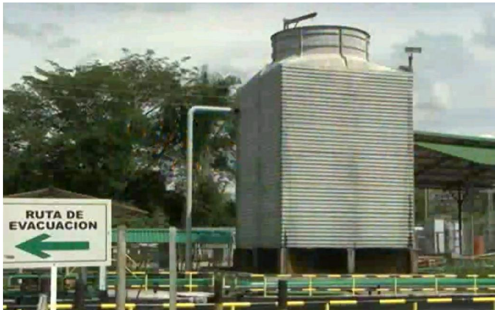
Figura 14. Torre de enfriamiento, Estación Toldado.
