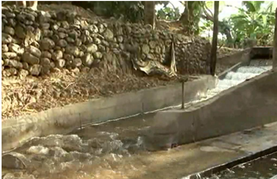
Figura 15. Cajilla de Vertimiento al río Tetuán, de la Estación Toldado.
