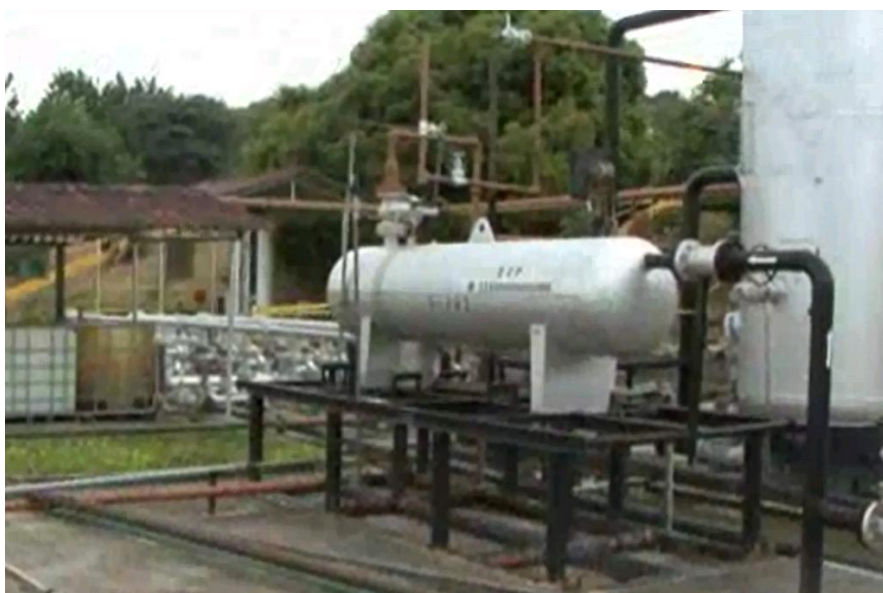
Figura 11. Separador general Estación Toldado.
