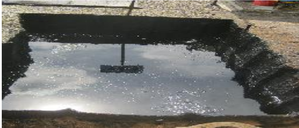
Figura 15. Tanque de recibo de arenas de baterías.
