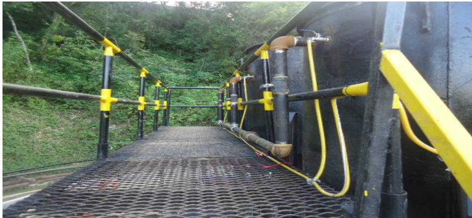
Figura 17. Pasarela de los Tanques cónicos de proceso.
