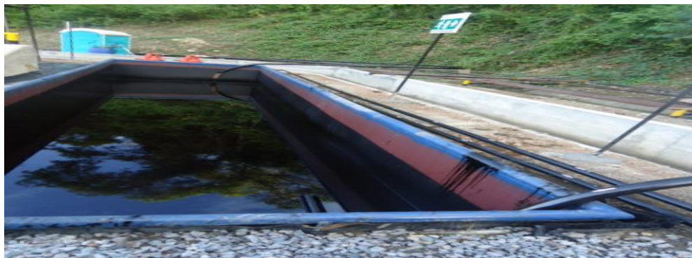
Figura 14. Tanque almacenamiento de arenas del CPF.
