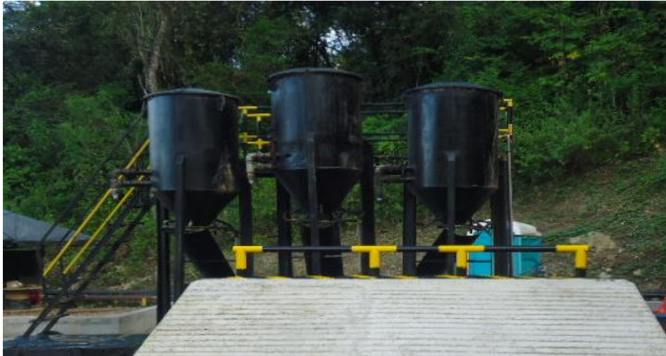
Figura 16. Tanques cónicos de proceso.
