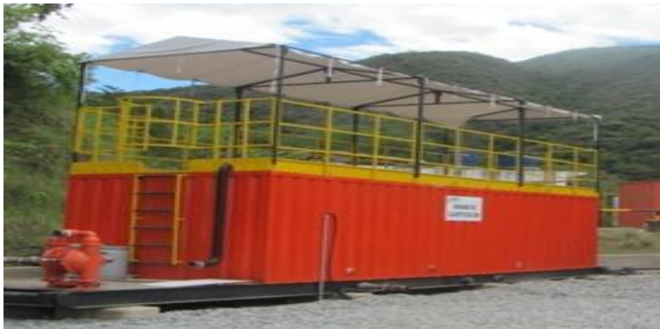
Figura 22. Unidad de Clarificación.
