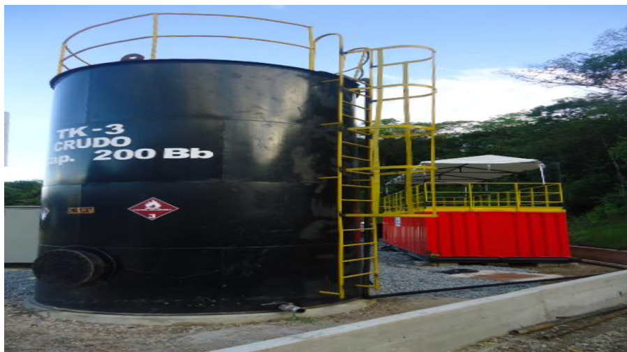
Figura 19. Tanque de almacenamiento de crudo.
