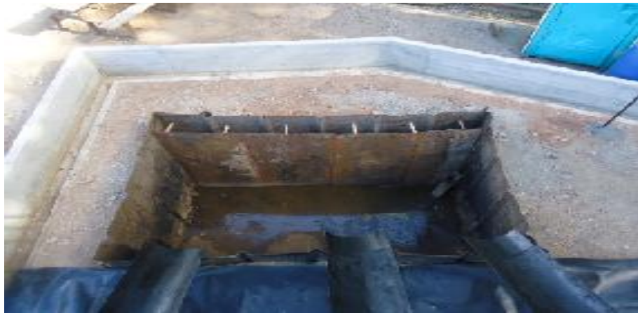
Figura 20. Tanque almacenamiento de arenas lavadas.
