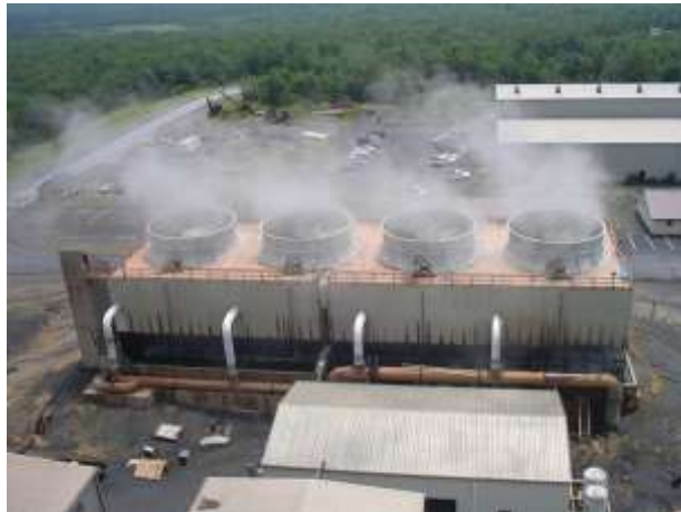
Figura 29. Torre de enfriamiento.
