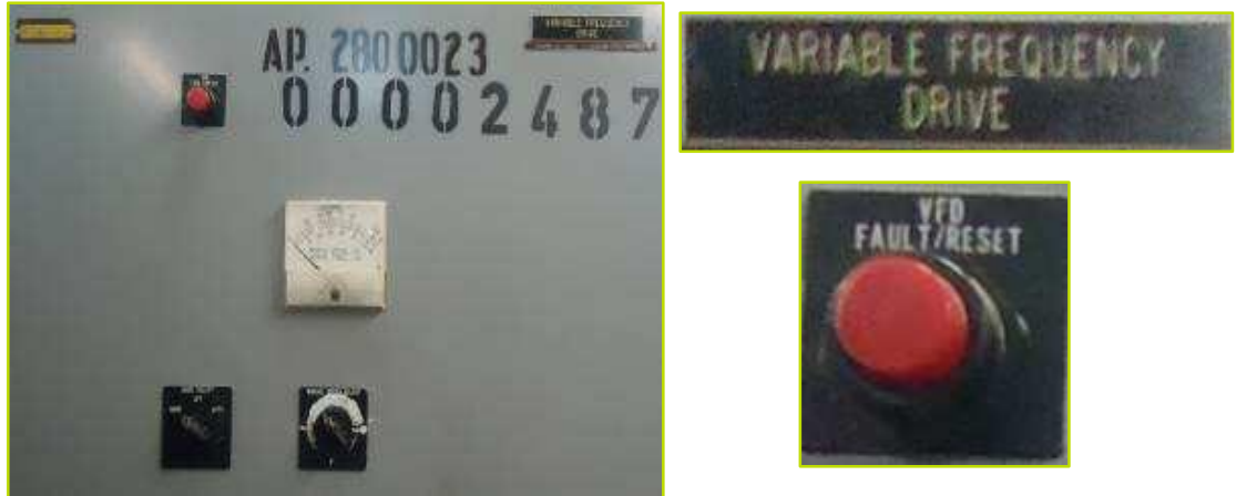
Figura 12. Variador de velocidad Robicon. Botón Fault/Reset.
