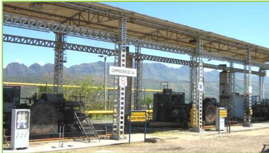
Figura No.40 Compresores de gas Ajax
