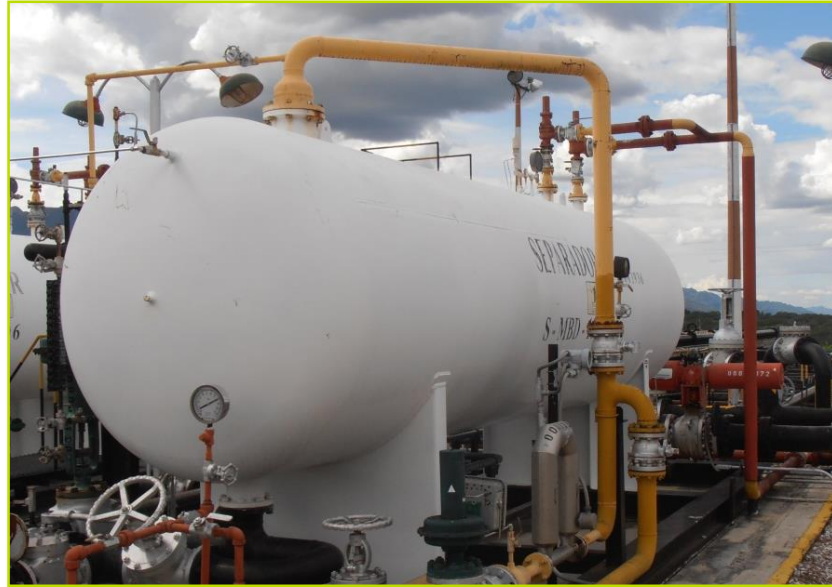
Figura No.8 Separador Bifásico (S-MBD-105)
