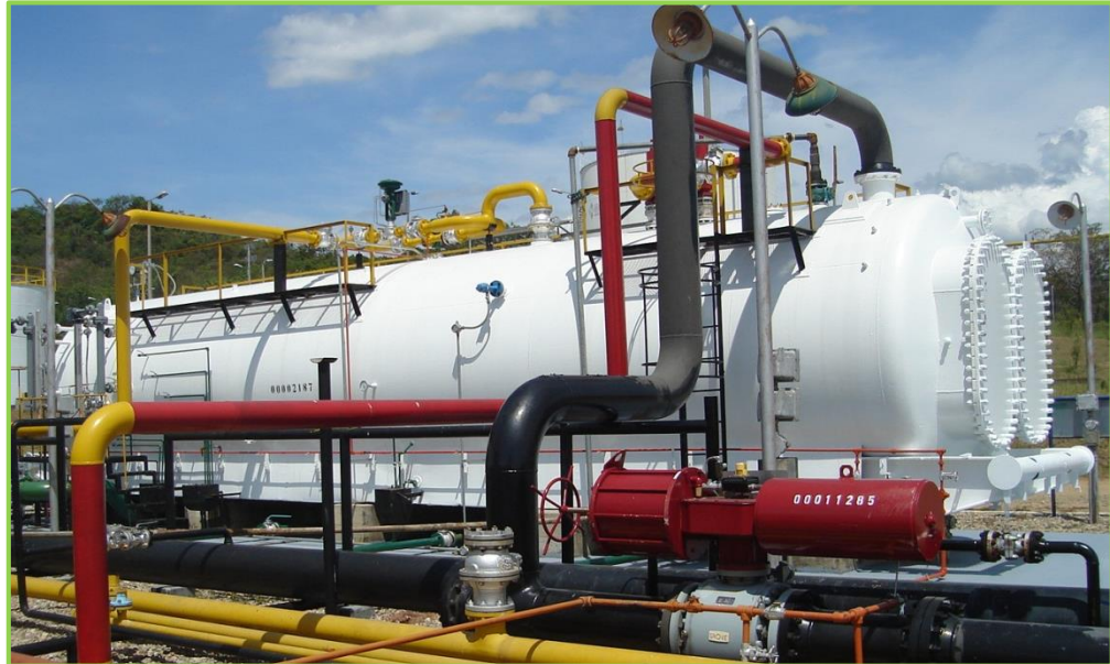
Figura No.20 Separador trifásico (FWKO.-S-MAM 102)
