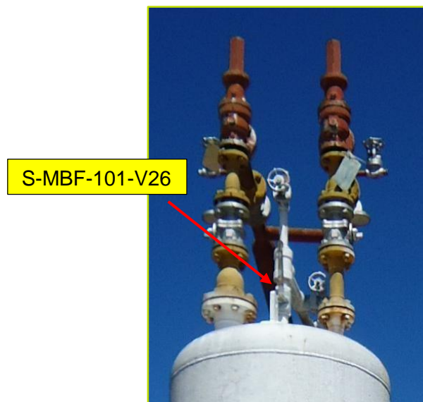
Figura 7. Válvula de la línea de control de nivel del Scrubber S- MBF-101.
