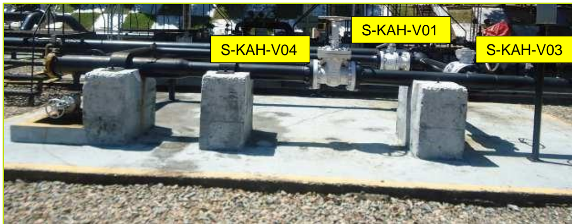
Figura 2. Válvula de la Línea de Transferencia.
