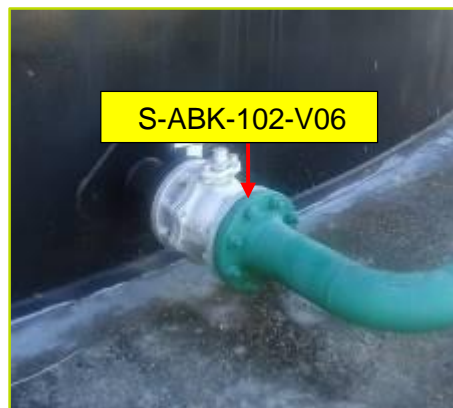
Figura 11. Válvula de drenaje del Gun Barrel S-ABK-102.
