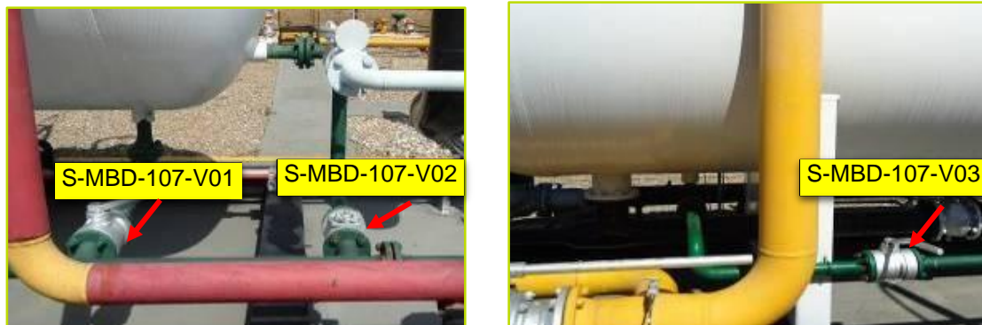
Figura 10. Válvulas de drenaje del Separador S-MBD-107.
