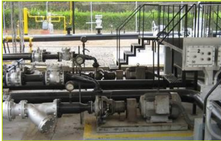
Figura No.34 Bombas de Recirculación
