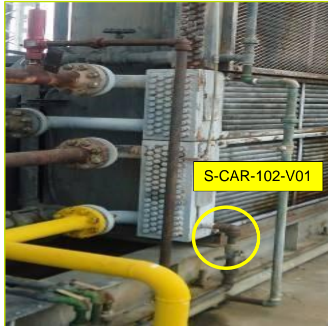
Figura 18. Válvula de Alivio o Venteo del Compresor de Gas Ajax S-CAR-102-V01.
