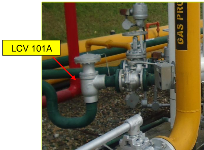
Figura 5. Válvula controladora LCV-101A del Scrubber S-MBF-101.
