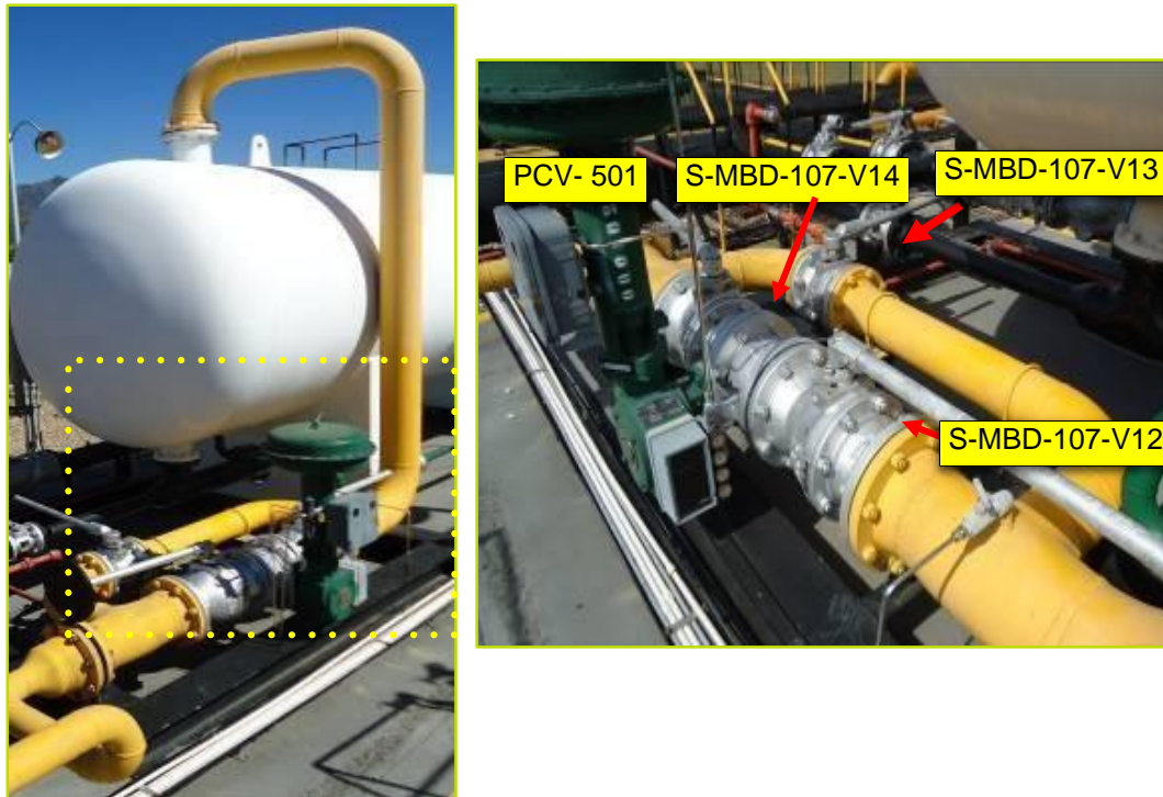
Figura 11. Válvulas de salida del gas del Separador S-MDB-107.
