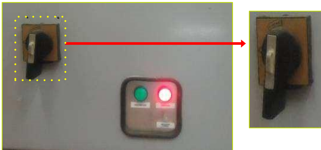
Figura 4. Breaker de la bomba de transferencia de crudo S-PAY-101A.
