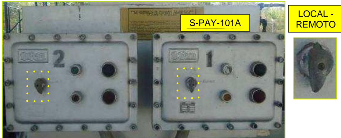
Figura 5. Panel de control local de las bombas S-PAY-101A.
