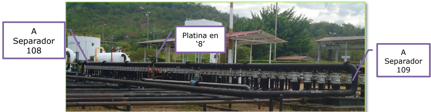
Figura No. 4 Colector de Prueba
