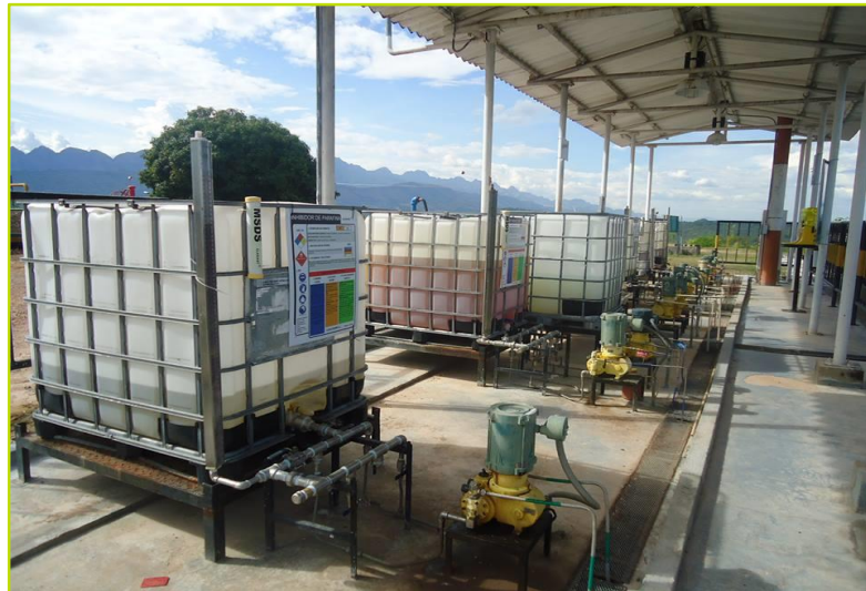
Figura No.5 Bombas y tanques de inyección de química
