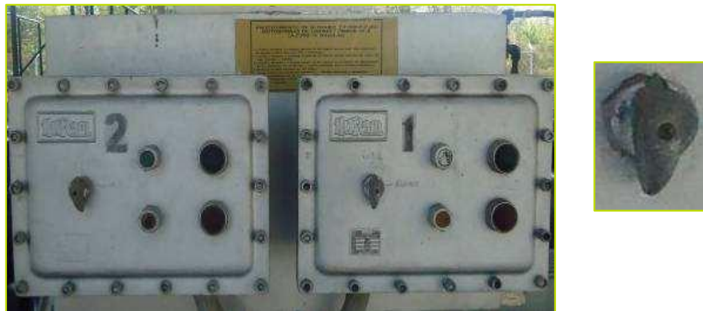
Figura 13. Panel de Control de la Bomba S-PAY-101B.
