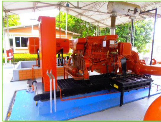
Figura No.54 Bomba de Agua Contra Incendios
