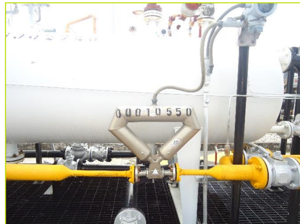
Figura No.23 Medidor tipo Coriolis
