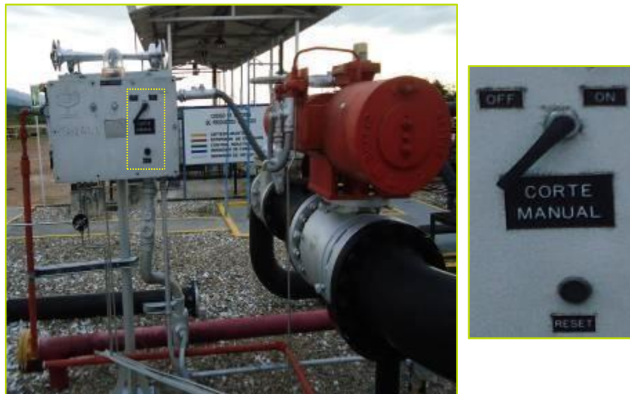
Figura 4. Panel de control de la válvula SDV-501.
