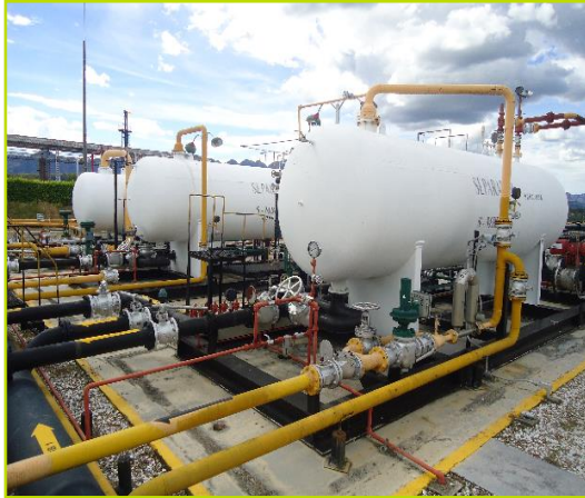
Figura No 6. Proceso de separación bifásica
