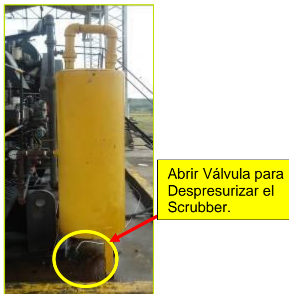
Figura 24. Scrubber de Gas Consumo del Compresor de Gas Ajax S-CAR-102.
