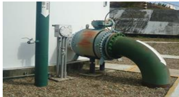
Figura 5. Válvula de salida del Skimming Tank S-ABM-5000-2.
