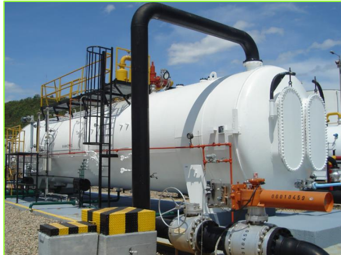
Figura No.18 Separador trifásico (FWKO S-MAM 101)
