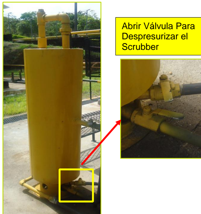
Figura 12. Scrubber del Gas Consumo del Compresor de Gas Ajax S-CAR-101.
