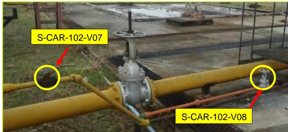
Figura 23. Válvula Gas y Aire Consumo Motor del Compresor de Gas Ajax-102.
