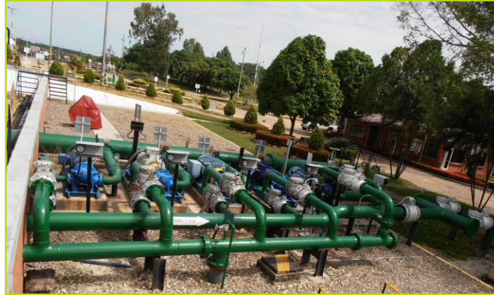
Figura No.48 Bombas de transferencia de agua a Planta de Inyección (PIA)
