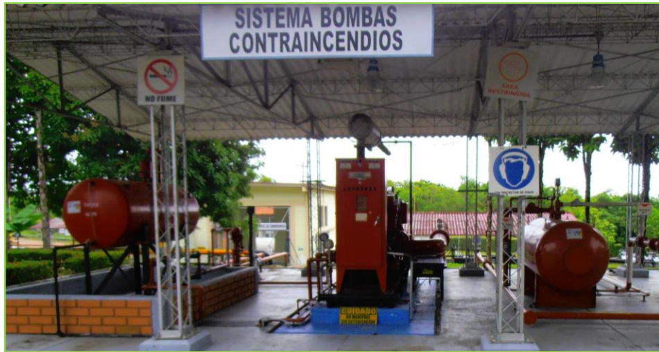
Figura No.52 Proceso contraincendios
