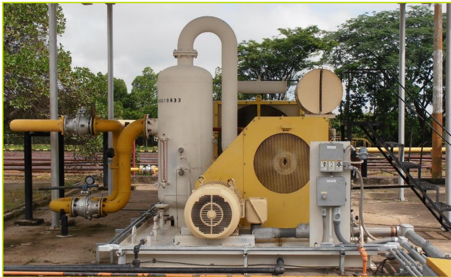
Figura No.38 Compresor para gas de anulares
