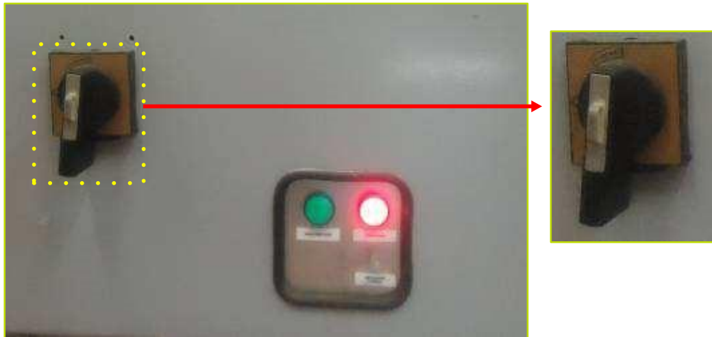
Figura 11. Breaker de la Bomba de Transferencia de Crudo S-PAY-101B.
