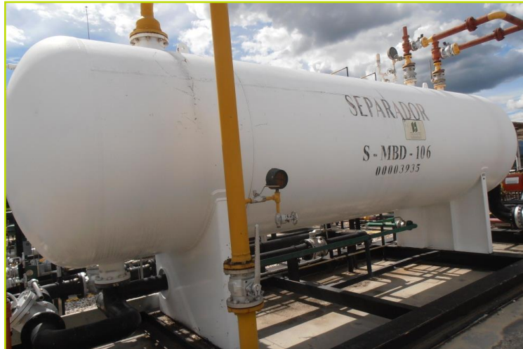
Figura No.10 Separador Bifásico (S-MBD-106)
