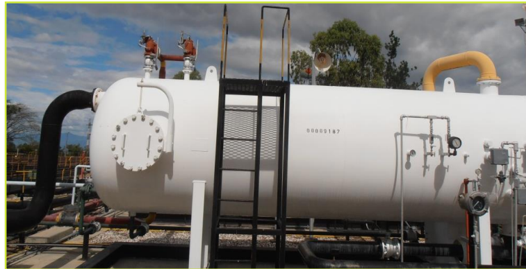
Figura No.12 Separador Bifásico (S-MBD-107)
