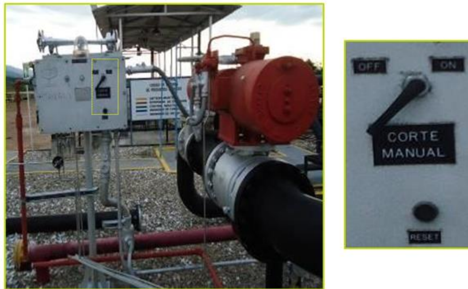
Figura 1. Panel de control de la válvula SDV 501.
