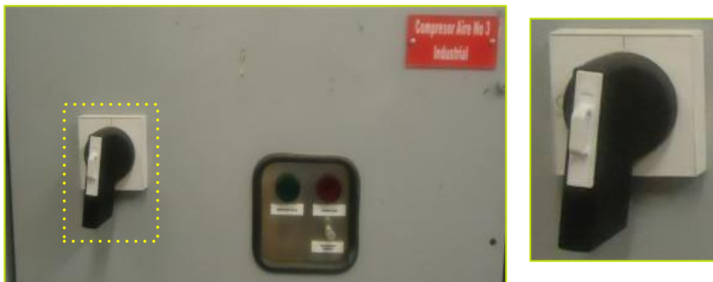
Figura 8. Breaker del compresor de aire S-MBE-103.
