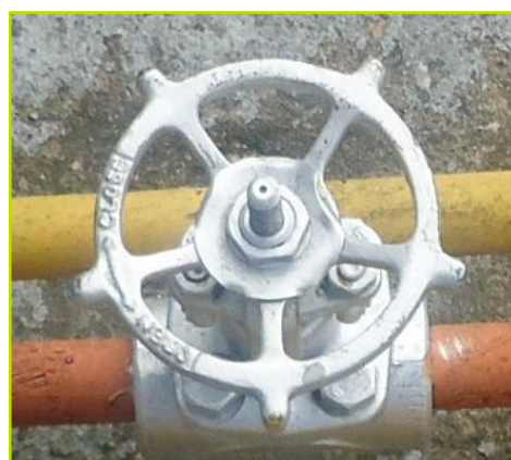
Figura 14. Válvula de aire S-CAR-101-V08 del Compresor de Gas Ajax S-CAR-101.
