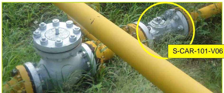
Figura 13. Válvula de Descarga del Compresor de Gas Ajax S-CAR-101.
