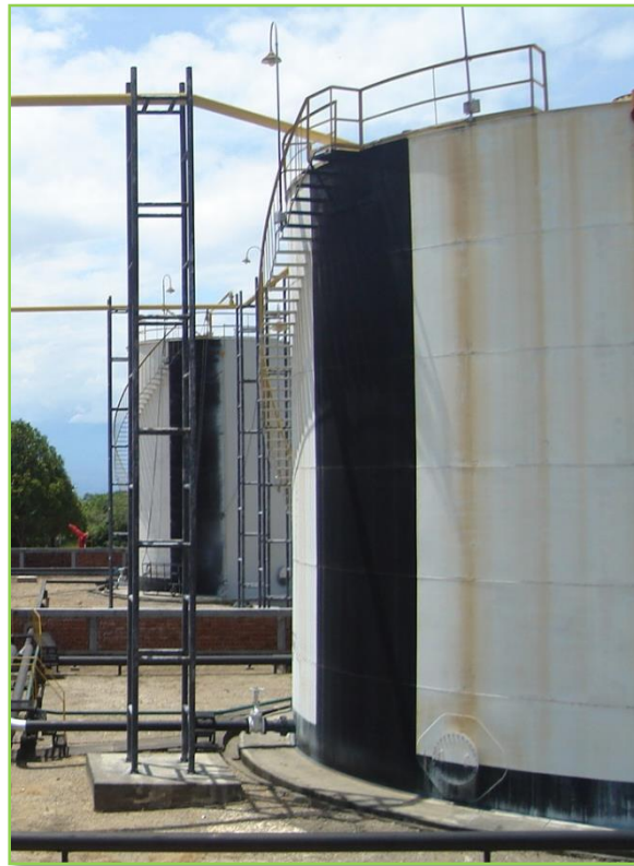
Figura No.29 Tanques de Almacenamiento y pruebas
