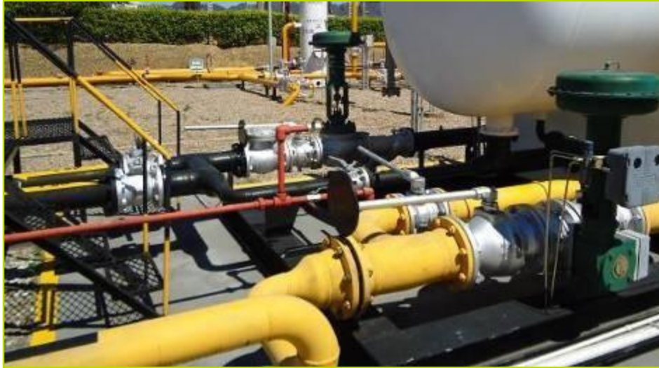
Figura 4. Válvulas de salida del Separador General.
