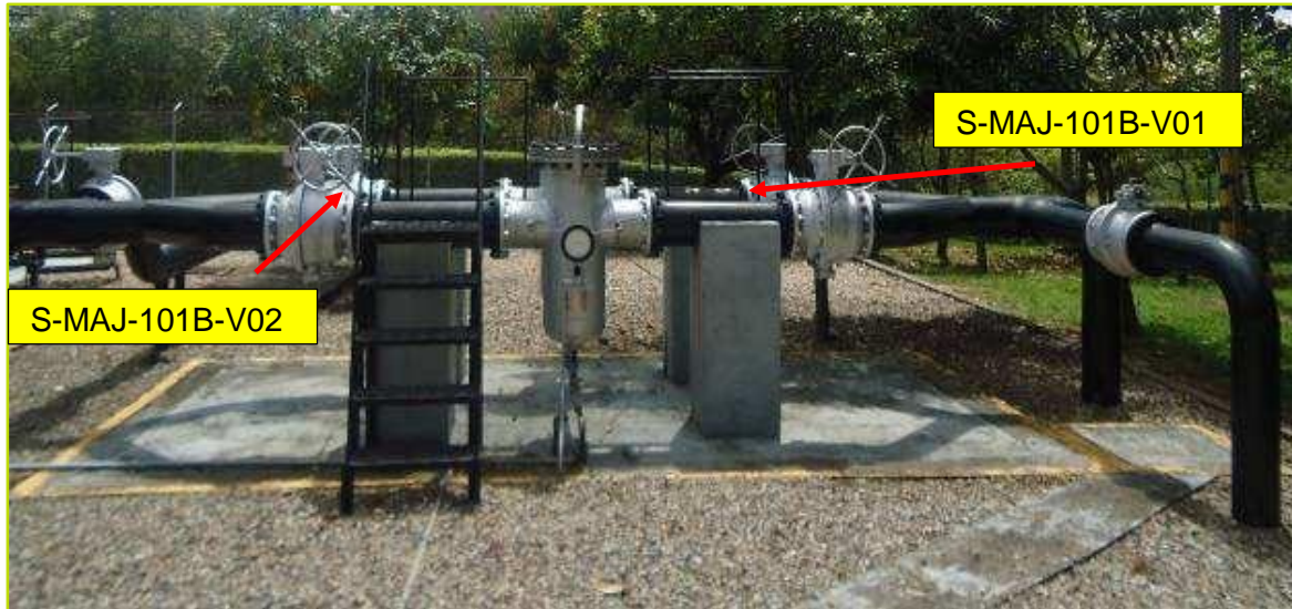
Figura 9. Válvulas del filtro S-MAJ-102B-V01/V02.
