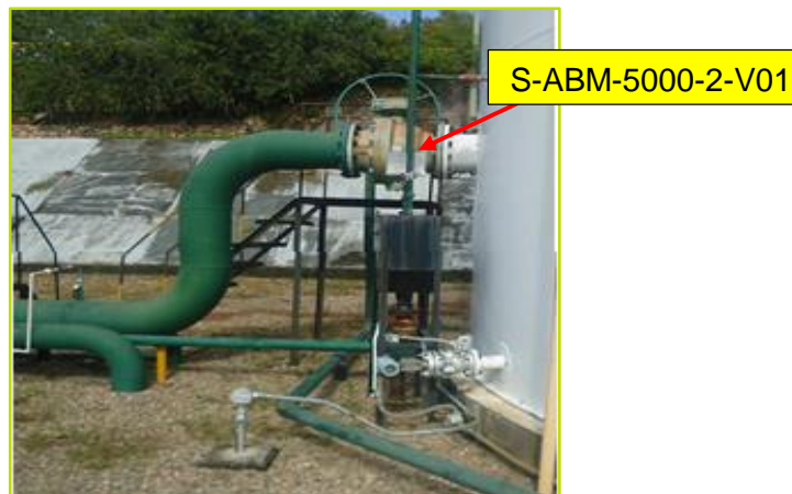
Figura 4. Válvula de entrada de agua de Gun Barrel.
