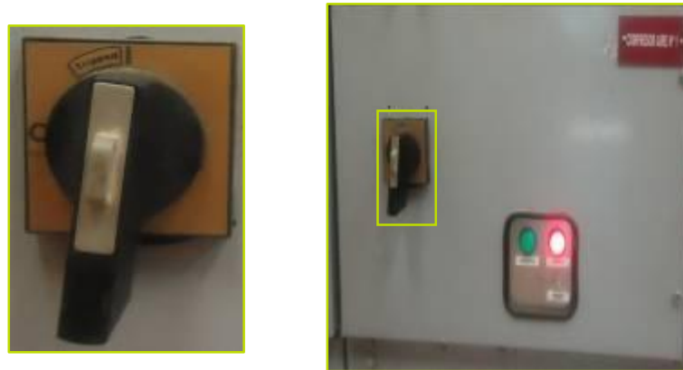
Figura 1. Breaker del Compresor de Aire S-MBE-101.
