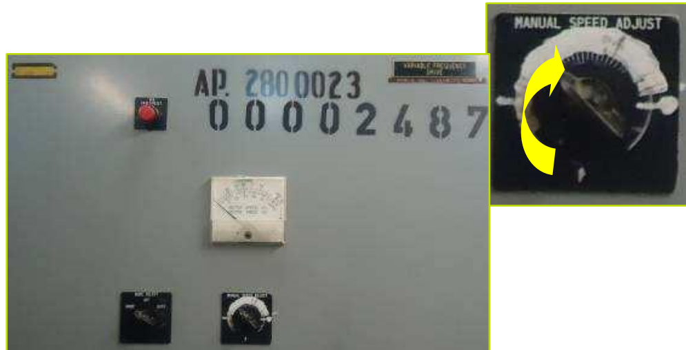
Figura 14. Variador de velocidad Robicon.
