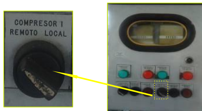
Figura 2. Selector Remoto-Local de control de los Compresores de Aire.
