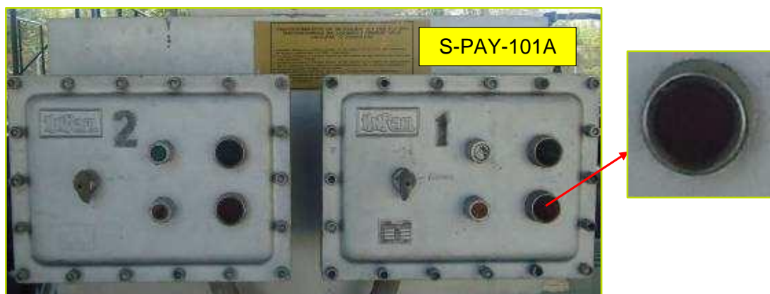
Figura 6. Panel de control local de las bombas S-PAY-101A.
