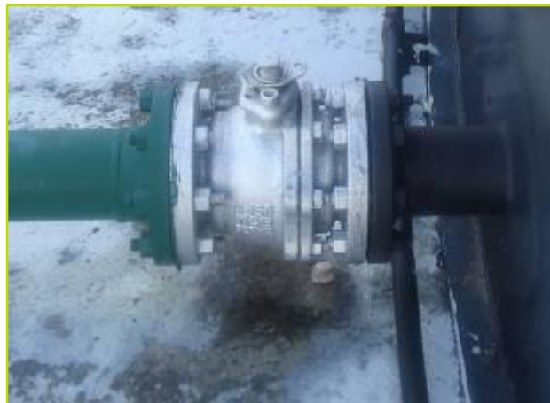
Figura 10. Válvula de drenaje del Gun Barrel S- ABK-101.
