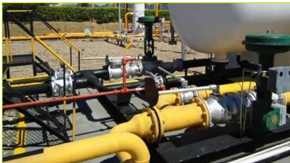
Figura 4. Válvulas de salida del Separador General.
