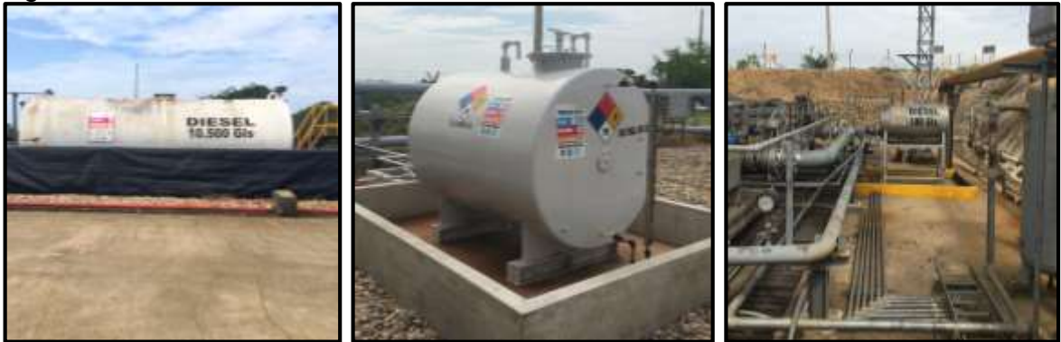
Figura 38. Sistema de combustible diésel de BA GX-39
