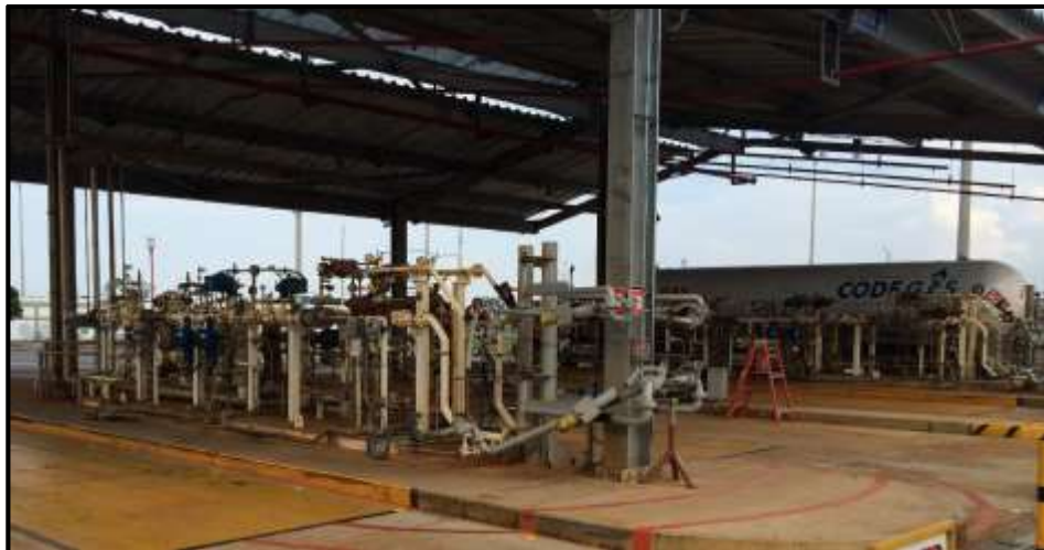
Figura 23. Llenadero de GLP
