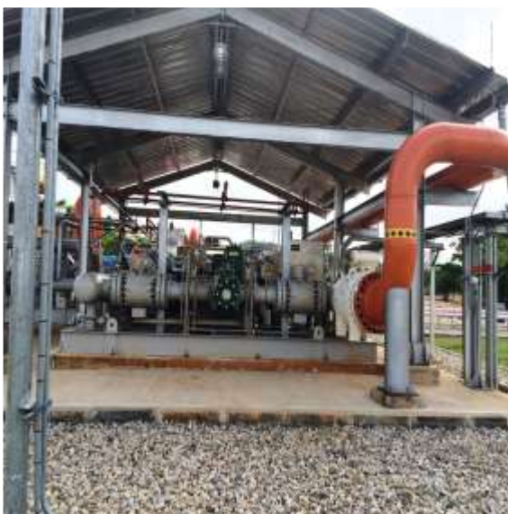
Área de filtros y compresión
