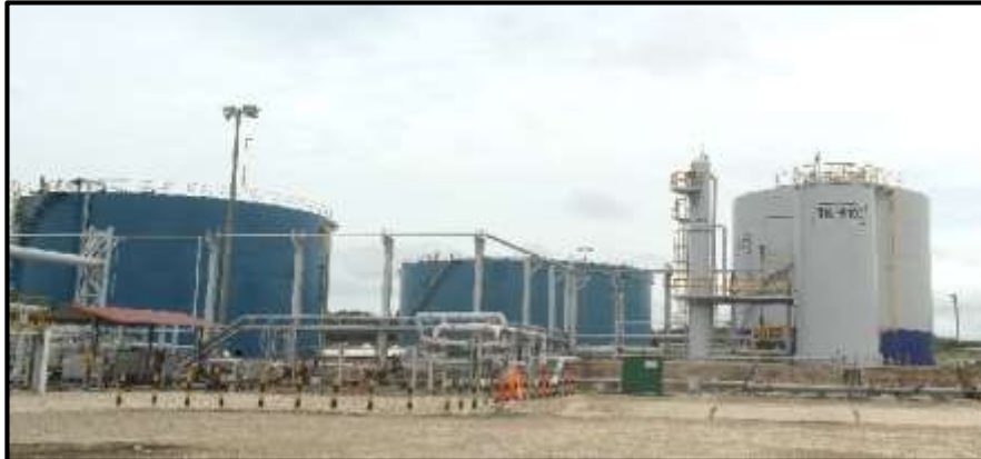
Figura 8. Tanques de almacenamiento crudo y agua
