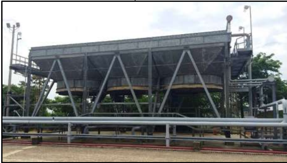
Figura 30. Sistema de enfriamiento de producción de BA GX-39
