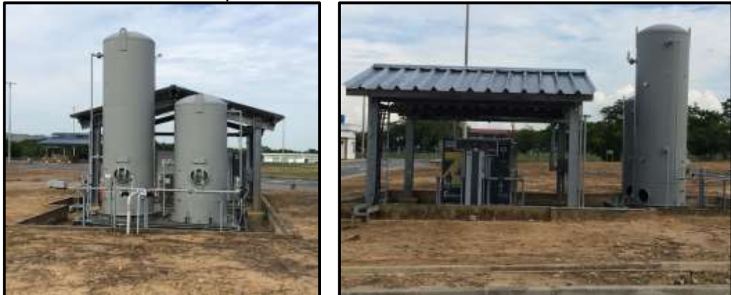
Figura 25. Sistema de compresión de aire de llenadero de GLP
