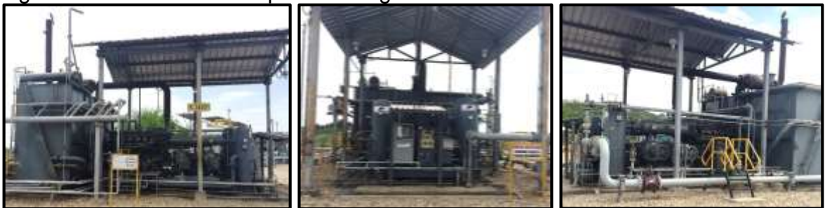
Figura 34. Sistema de compresión de gas de BA GX-39
