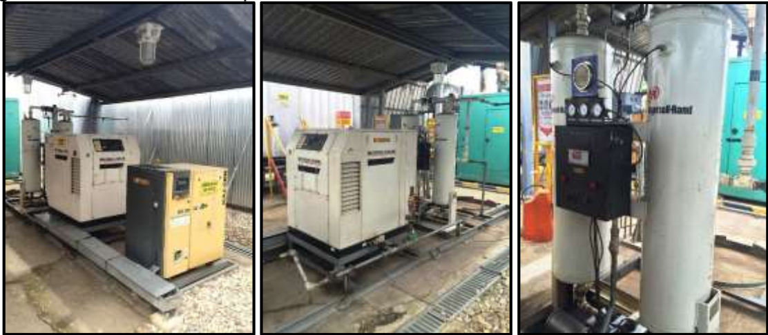
Figura 37. Sistema de compresores de aire de BA GX-39
