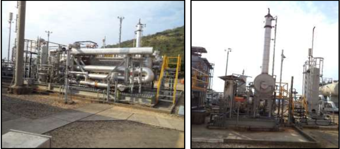
Figura 16. Unidad de tratamiento de gas combustible de Recetor
