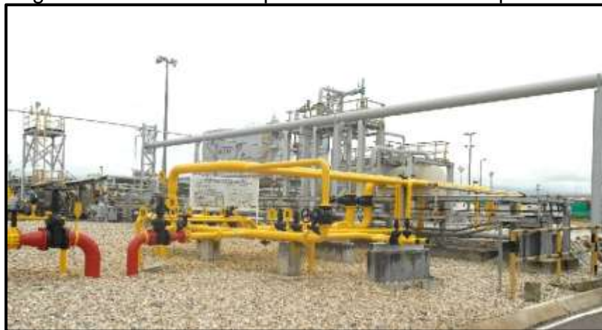
Figura 5. Líneas de transporte de crudo hacia separadores
