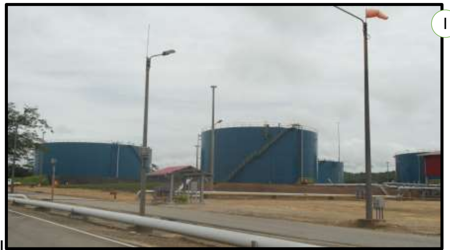
Descripción: G) Sistema de osmosis para la obtención de agua destilada. H) Sistema de teas. I) Tanques de almacenamiento de crudo capacidad: 25000 BBLS.
