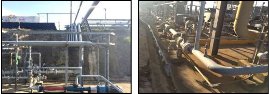
Figura 33. Tuberías de flujo de recirculación de BA GX-39
