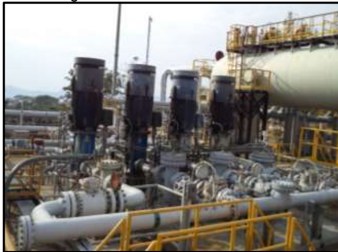
Figura 15. Bombas centrífugas de transferencia de crudo de Recetor
