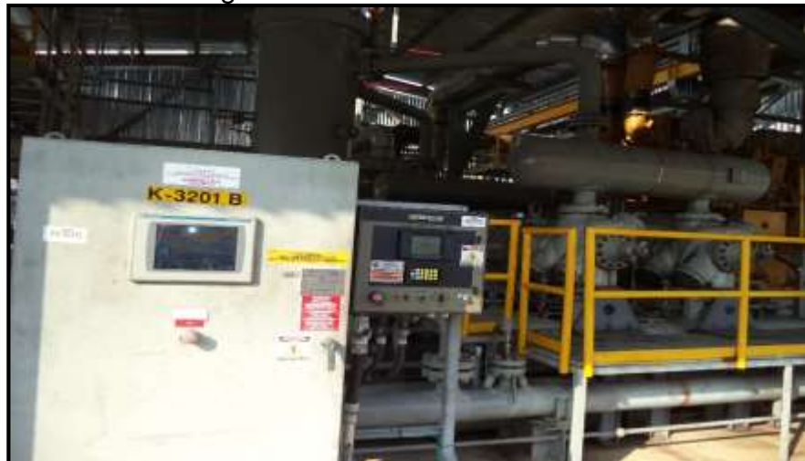
Figura 17. Sistema boosting de Recetor
