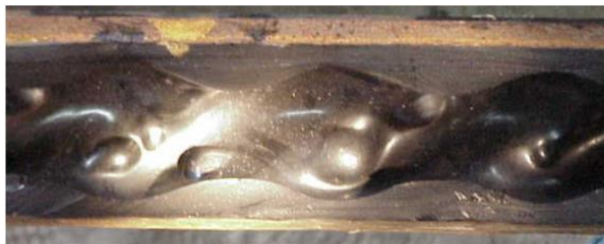
Figura 11 Descompresión explosiva (Fuente: Base de datos TDA)
