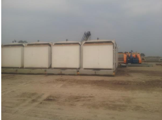
Figura 36. Tanques de lodos
