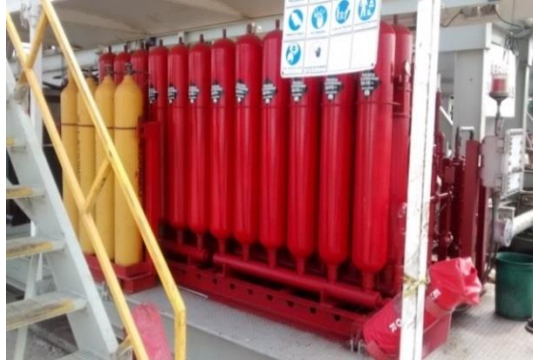
Figura 14. Sistema de acumuladores
