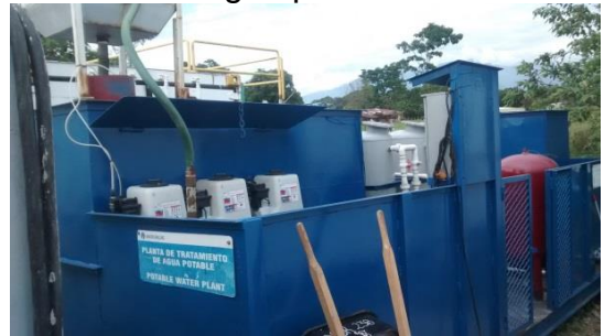
Figura 65. Planta de tratamiento de agua potable
