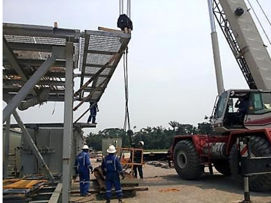
Figura 69. Arme de la estructura de los scalpers
