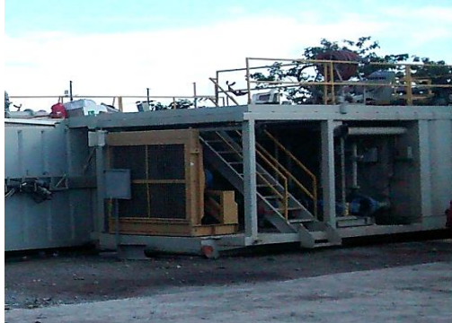
Figura 13. Unidad de Enfriamiento
