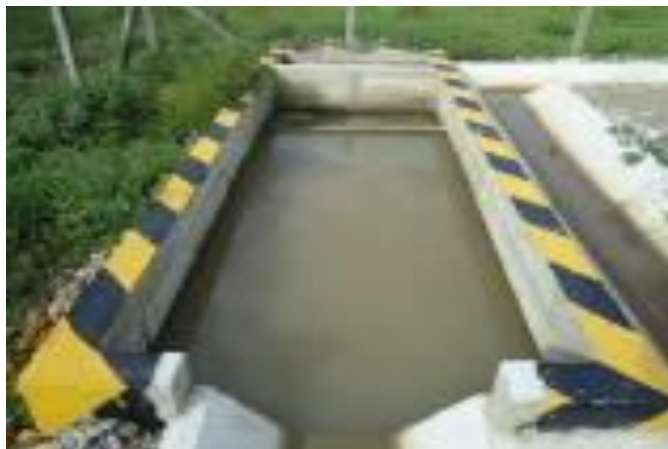
Figura 3. Desarenador de aguas lluvias de la cuneta perimetral
