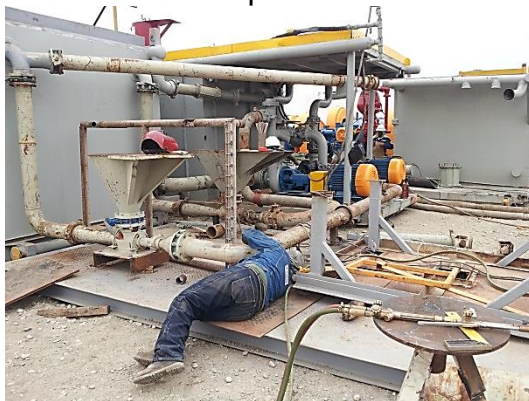
Figura 71. Armando tolvas para adición de química
