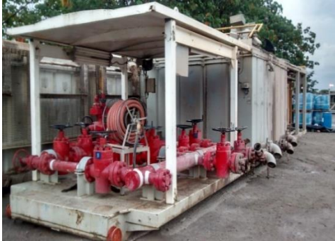
Figura 17. Múltiple de estrangulamiento (Choque manifold)
