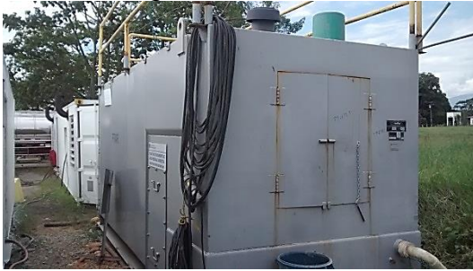
Figura 66. Planta de tratamiento de aguas residuales
