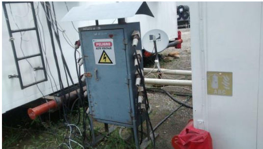
Figura 64. Satélite de conexiones eléctricas
