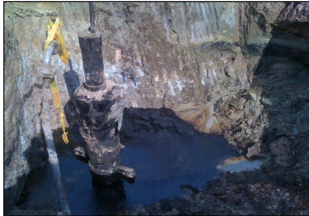
Imagen 1: Impacto ambiental de un pozo mal abandonado debido a la ausencia de cemento detrás del revestimiento (1)
