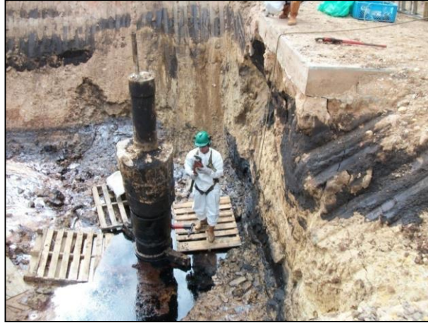
Imagen 2: Impacto ambiental de un pozo mal abandonado debido a la ausencia de cemento detrás del revestimiento (2)
