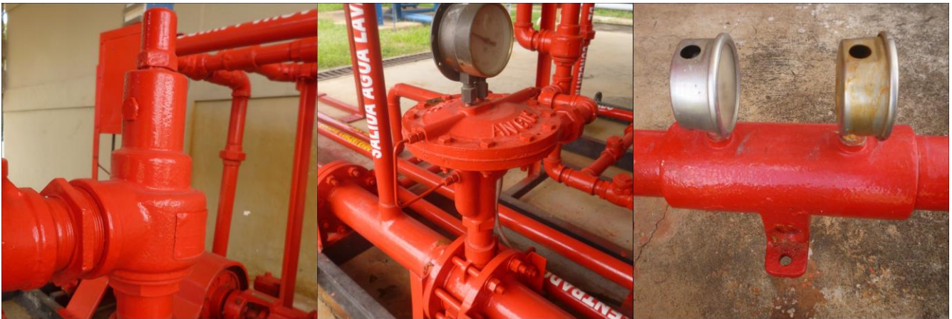
Fotografía 99. Válvula de exceso / Proporcionador de espuma por balanceo de presión / Generador de espuma de alta contrapresión
