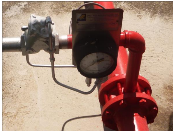
Fotografía 103. Proporcionador de espuma balanceado por presión
