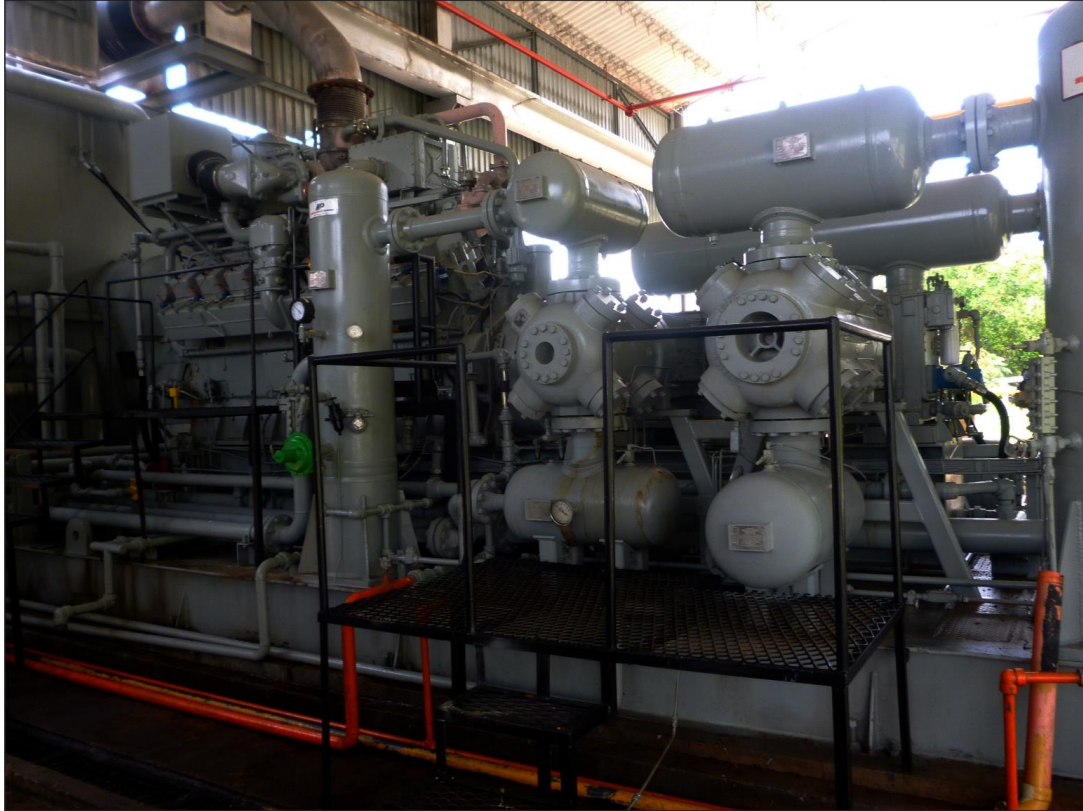
Fotografía 53. Compresor de gas (C3)
