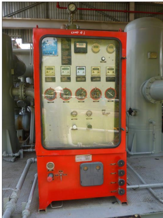
Fotografía 35. Panel de control (C6)
