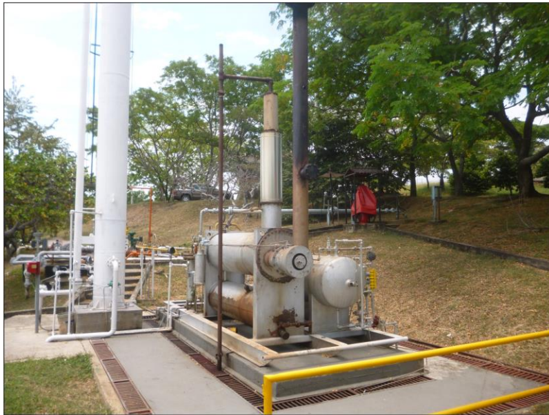
Fotografía 63. Sistema de regeneración de glicol
