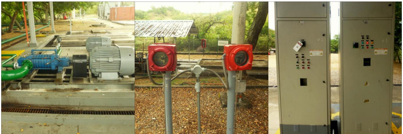
Fotografía 42. Bomba de despacho de agua /Switches de presión alta y baja / Variador
