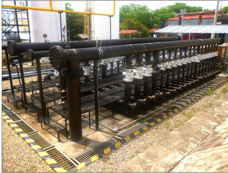
Fotografía 3. Múltiple de la estación
