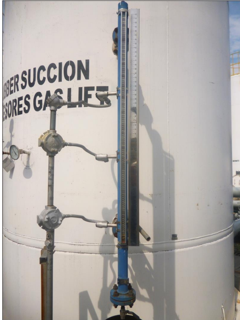
Fotografía 52. Indicador de nivel del scrubber general
