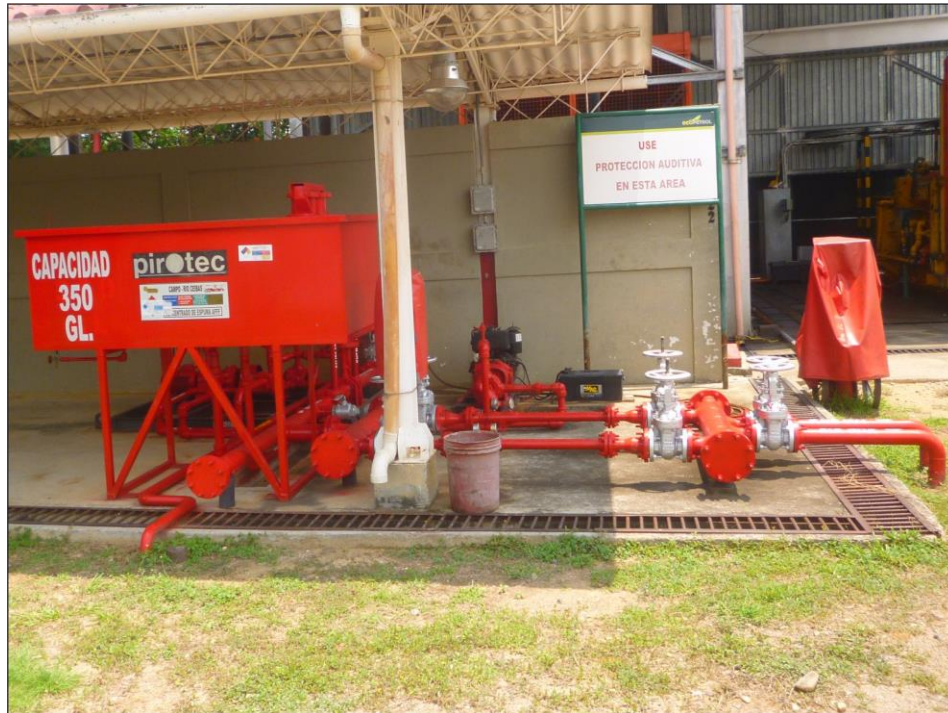
Fotografía 96. Sistema de inyección de espuma
