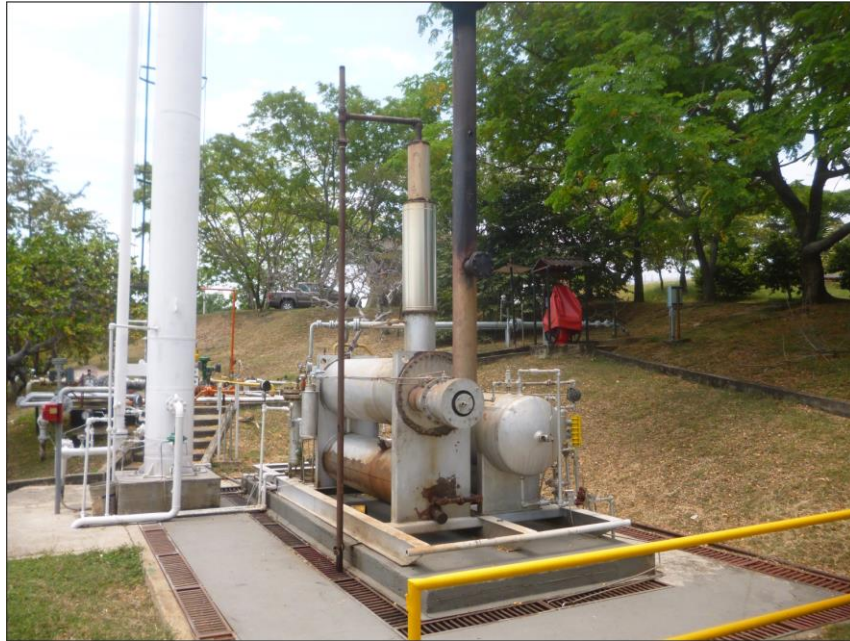
Fotografía 67. Rehervidor de glicol (Reboiler)
