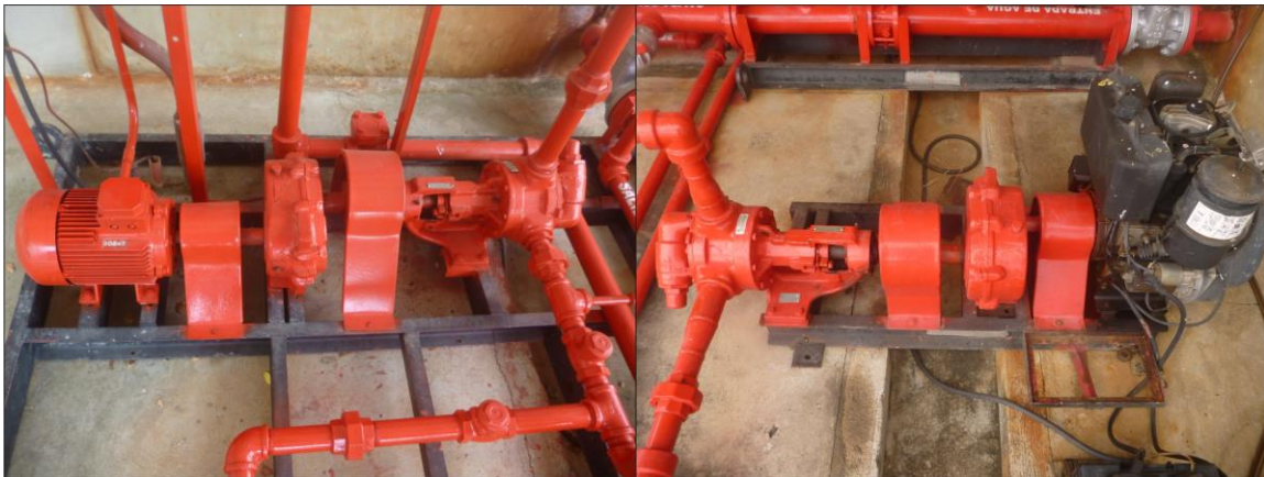
Fotografía 98. Motobombas de concentrado (eléctrica/combustión interna)
