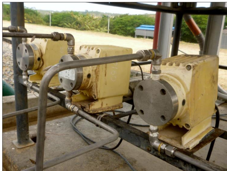
Fotografía 8. Bombas dosificadoras de químicos
