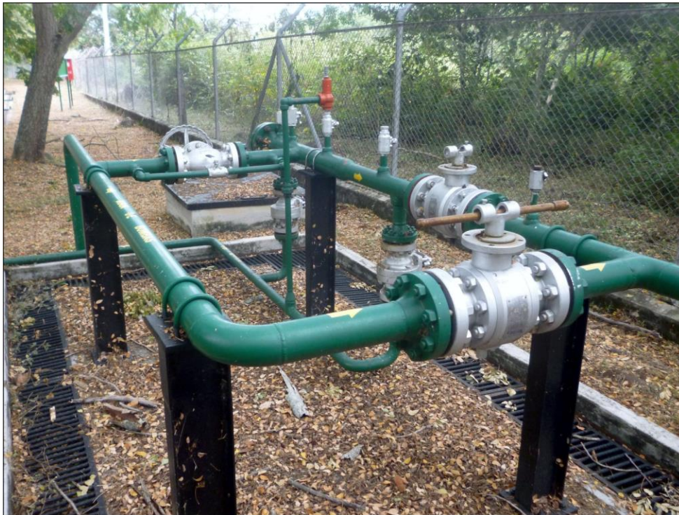
Fotografía 43. Trampa de lanzamiento para raspadores
