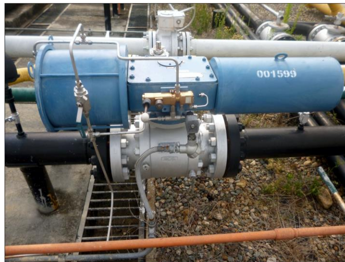
Fotografía 15. Válvula de shutdown (ESDV)
