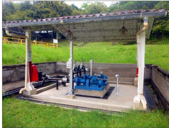
Fotografía 39. Bombas de recuperación de crudo
