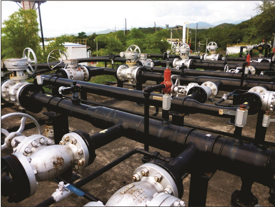
Fotografía 4. Trampas de recepción dentro de la estación Venado 1
