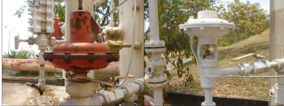
Fotografía 61. Válvulas de control de nivel
