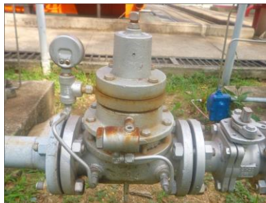
Fotografía 72. Válvula reguladora – reductora de presión
