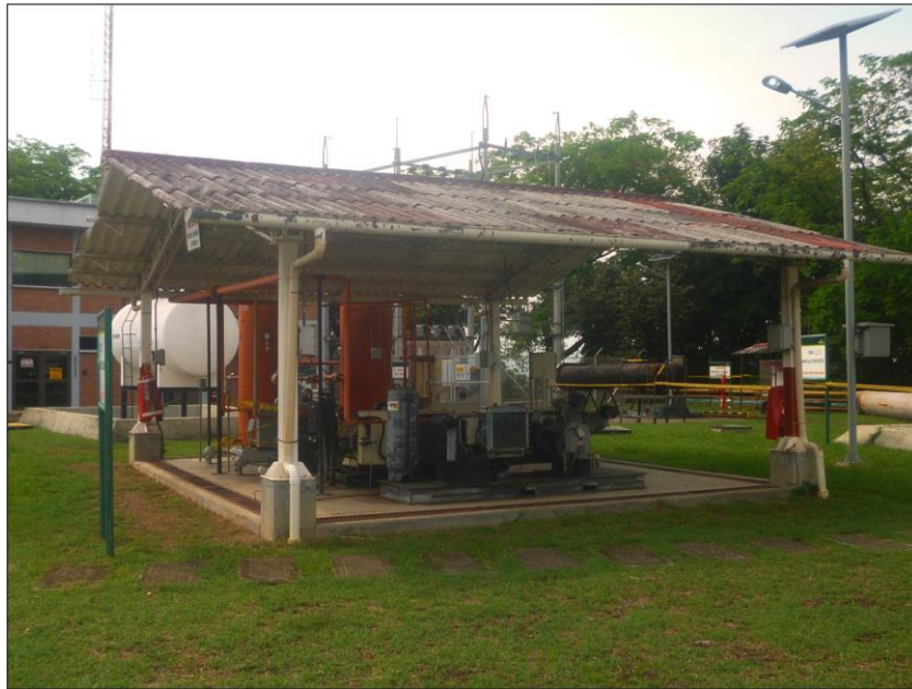
Fotografía 43. Sistema de compresión y suministro de aire
