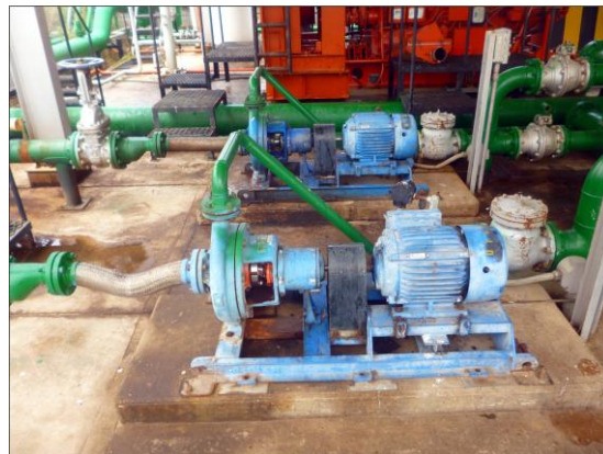
Fotografía 91. Bombas booster de inyección
