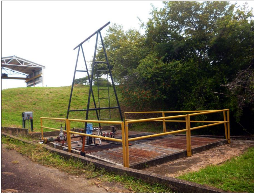
Fotografía 42. Sumidero de tanques de fiscalización
