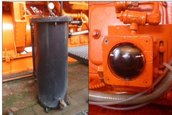
Fotografía 76. Filtro y visor de nivel de aceite
