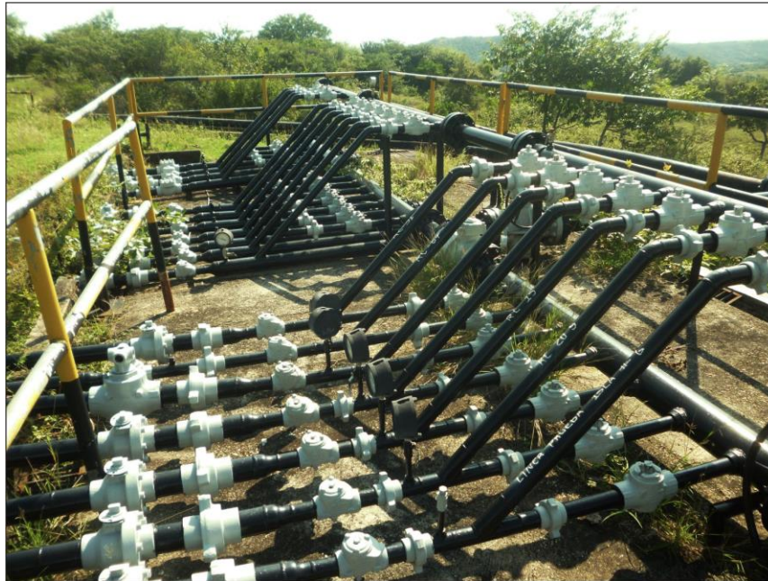
Fotografía 4. Múltiple de la Ye
