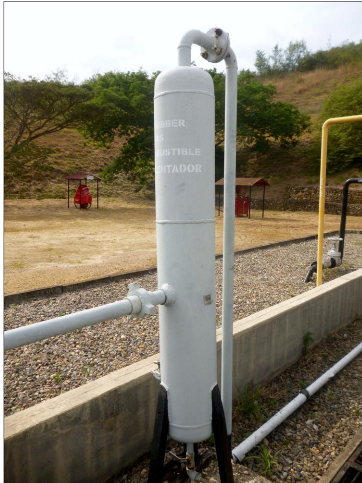
Fotografía 23. Scrubber de gas combustible al calentador
