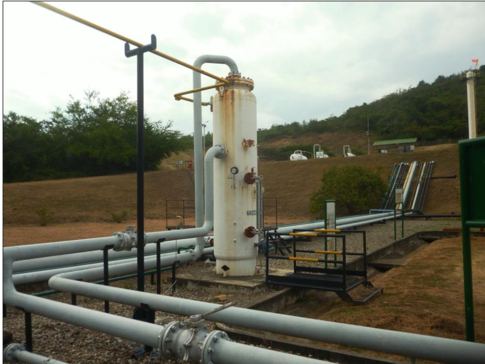
Fotografía 36. Sistema de gas combustible
