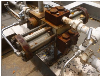
Fotografía 65. Bomba principal de glicol
