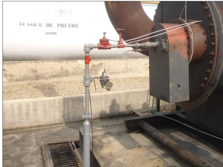
Fotografía 21. Subsistema de ignición
