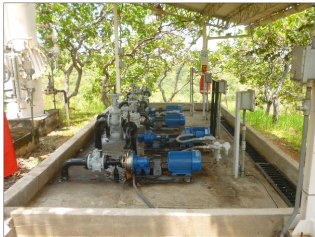
Fotografía 79. Bombas de drenaje de los scrubbers
