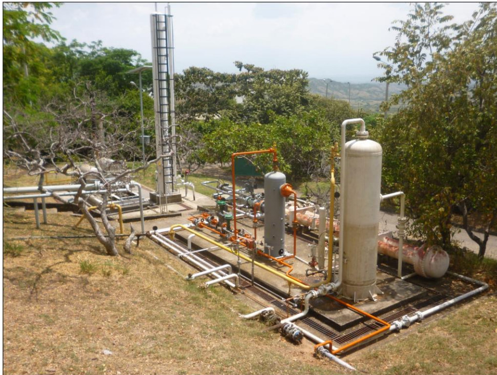
Fotografía 56. Planta de deshidratación de gas
