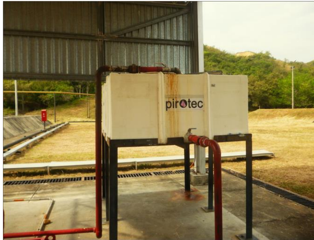
Fotografía 50. Tanque almacenador de concentrado espumante
