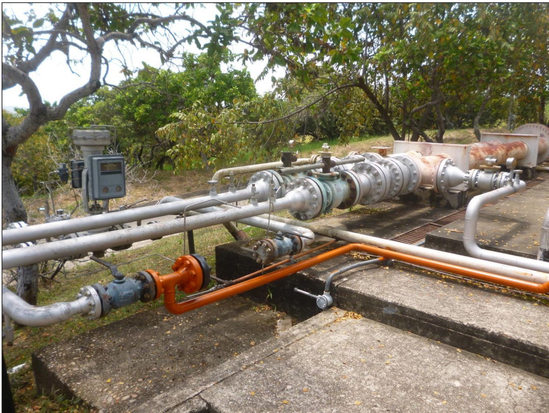
Fotografía 58. Intercambiador térmico gas - gas
