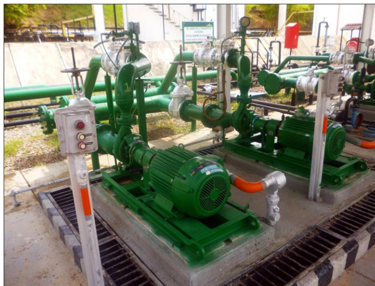
Fotografía 84. Bombas P-65-003 1 y 2
