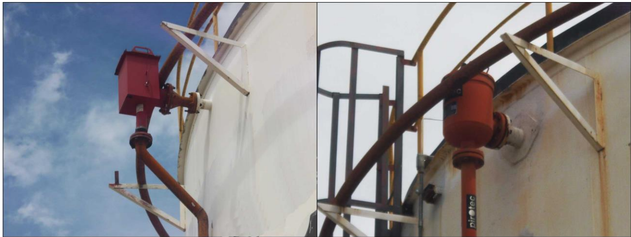
Fotografía 102. Vertedores de espuma GB-65-001 y TK-301-A
