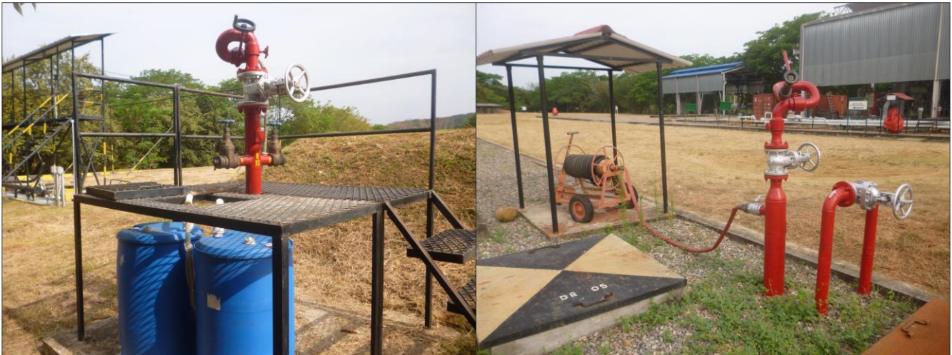
Fotografía 48. Hidrante monitor aspensor de espuma / Hidrante monitor aspensor de agua
