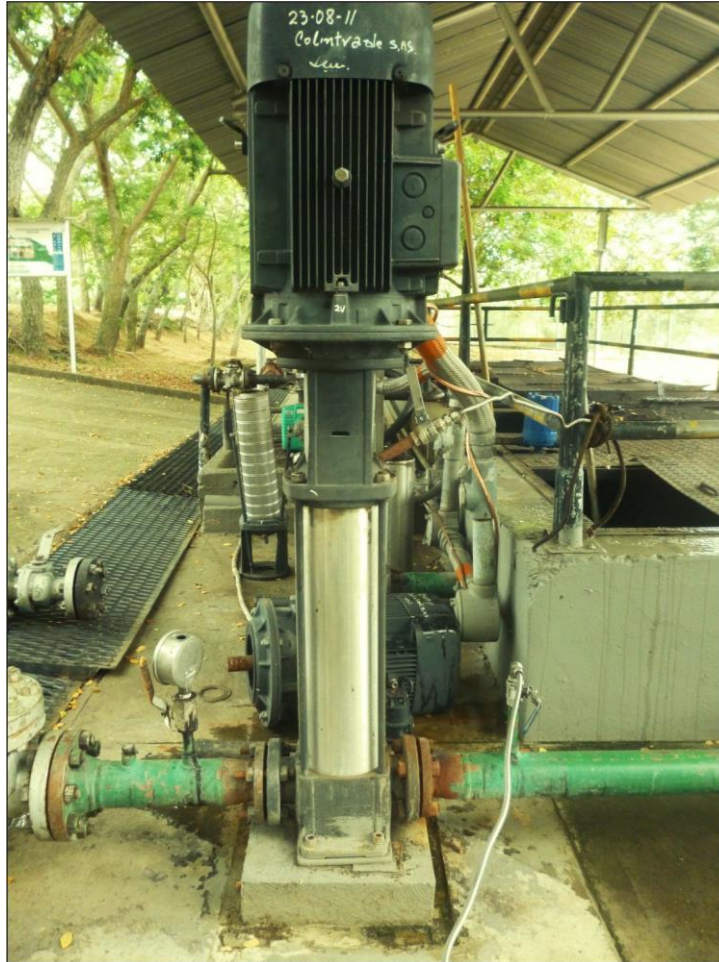
Fotografía 41. Bomba de recuperación de agua
