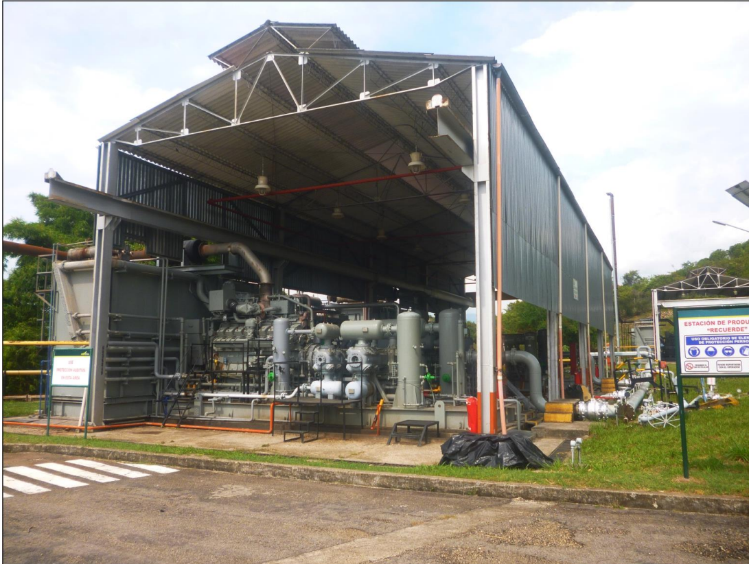
Fotografía 50. Área de compresores
