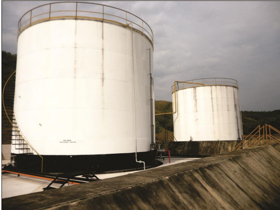
Fotografía 24. Tanques de almacenamiento de crudo (TK-2000-1 y TK-2000-2)
