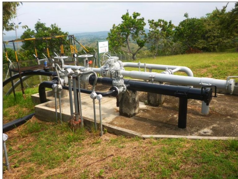
Fotografía 8. Trampa del oleoducto VENADO - LOS PINOS
