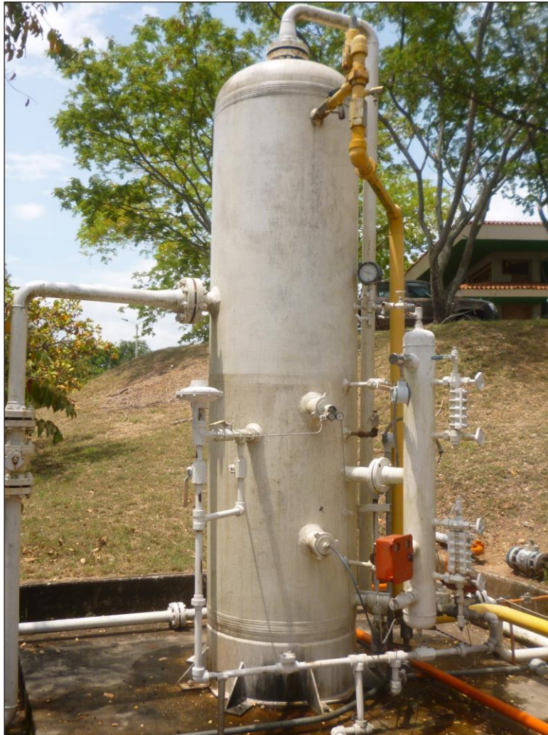
Fotografía 60. Scrubber de venta
