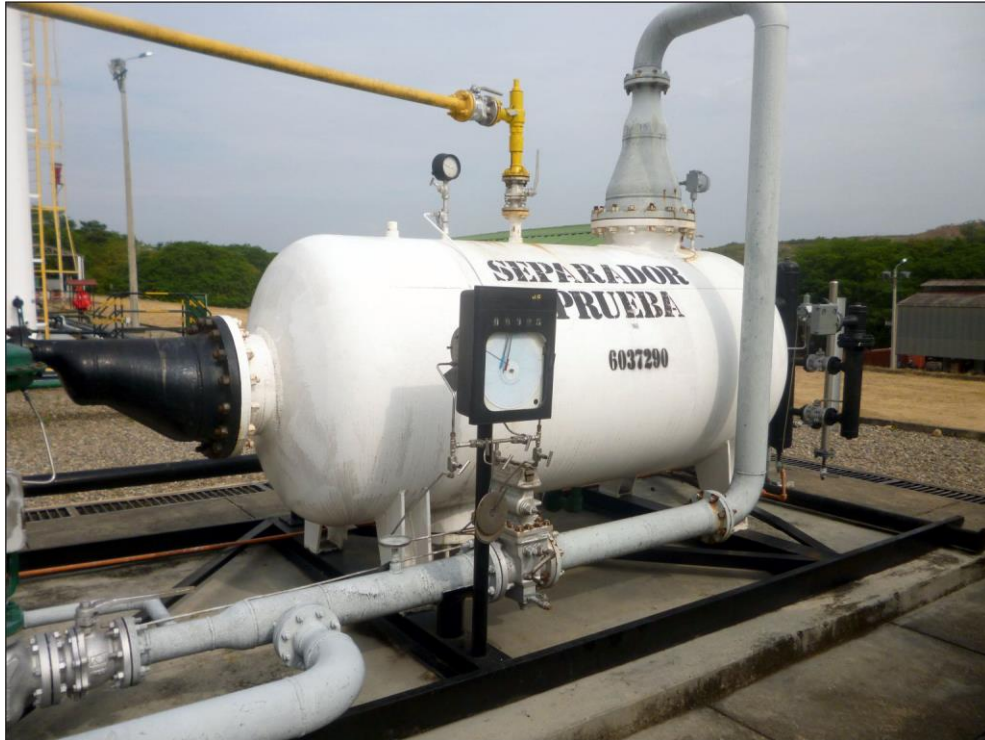
Fotografía 17. Separador de prueba
