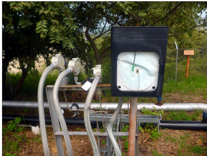
Fotografía 33. Switch y registrador de presión en el oleoducto
