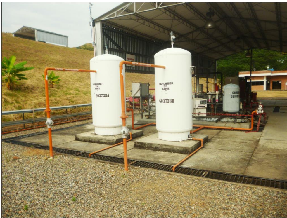
Fotografía 27. Sistema de compresión y suministro de aire
