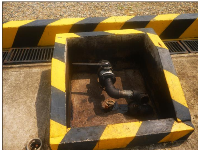
Fotografía 49. Válvula para cargue o descargue de vehículos cisterna
