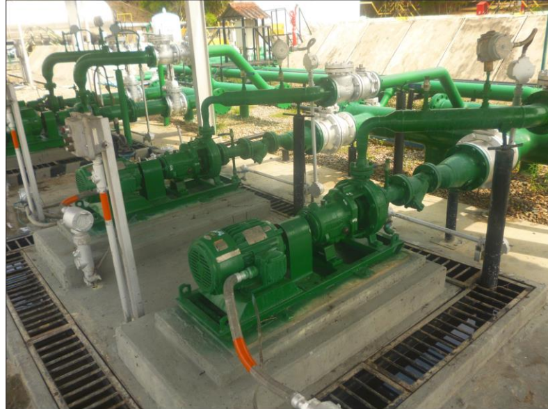
Fotografía 83. Bombas de recirculación del tanque clarificador
