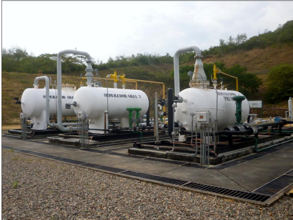
Fotografía 9. Área de separadores
