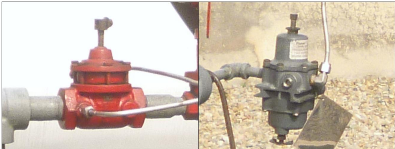
Fotografía 22. Válvula reguladora de gas al quemador / Válvula reguladora de gas al piloto
