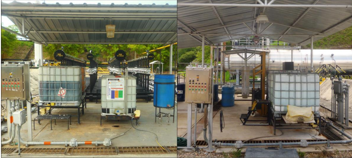
Fotografía 10. Casetas de inyección de químicos
