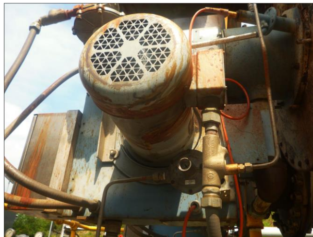
Fotografía 22. Motor eléctrico y transformador
