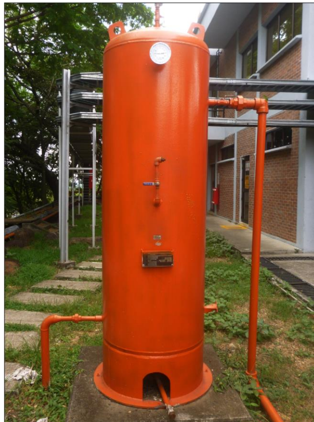
Fotografía 45. Acumulador de aire secundario (área de generadores)
