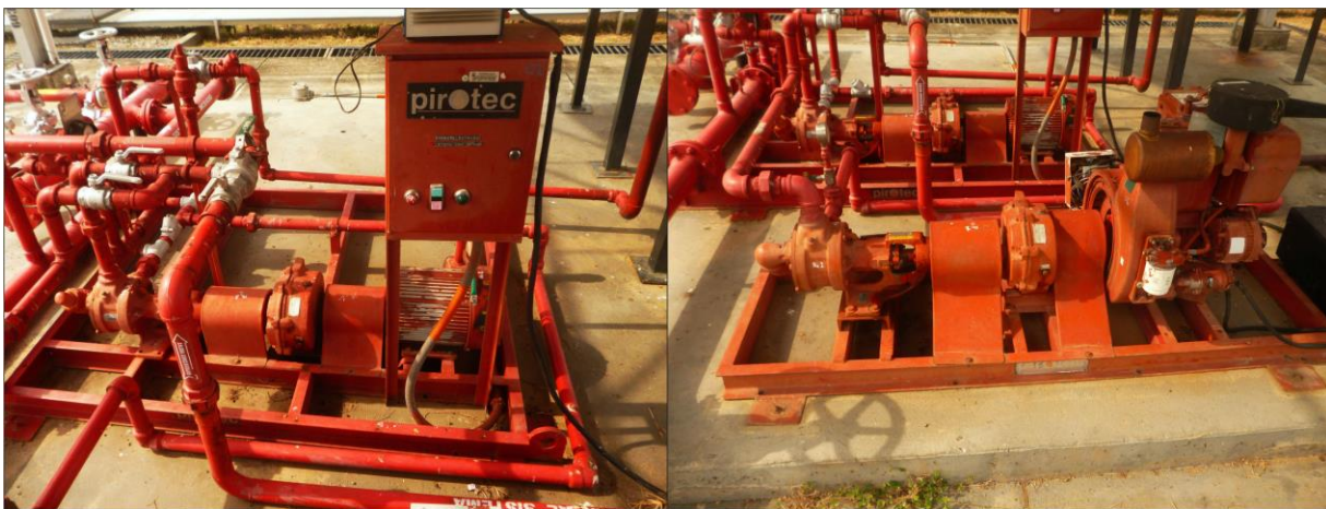
Fotografía 51. Motobombas de concentrado espumante (eléctrica / combustión interna)
