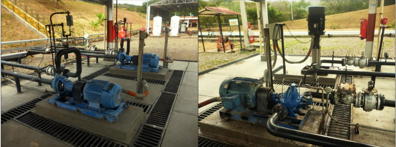
Fotografía 25. Bombas de recirculación / Bombas de despacho
