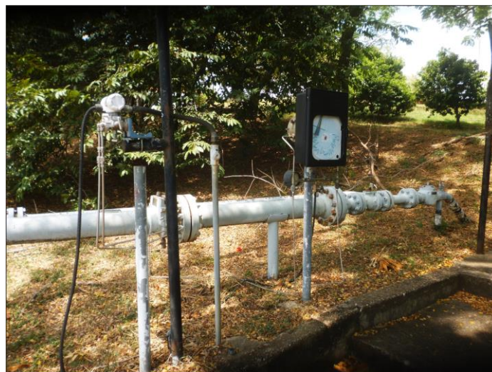
Fotografía 62. Tren de medición para gas de venta
