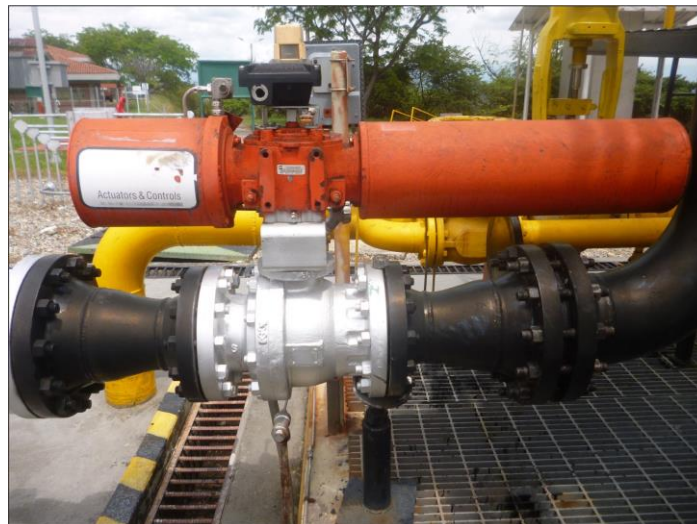
Fotografía 15. Válvula de shutdown (ESDV)
