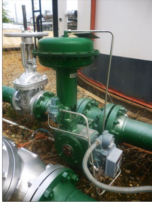
Fotografía 25. Válvula controladora de nivel de interfase
