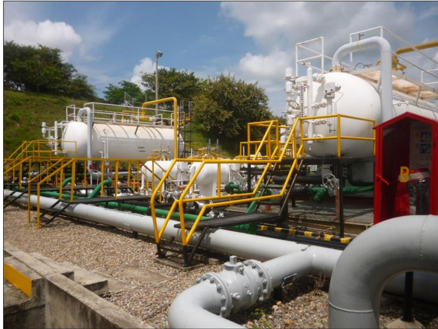
Fotografía 12. Área de separadores
