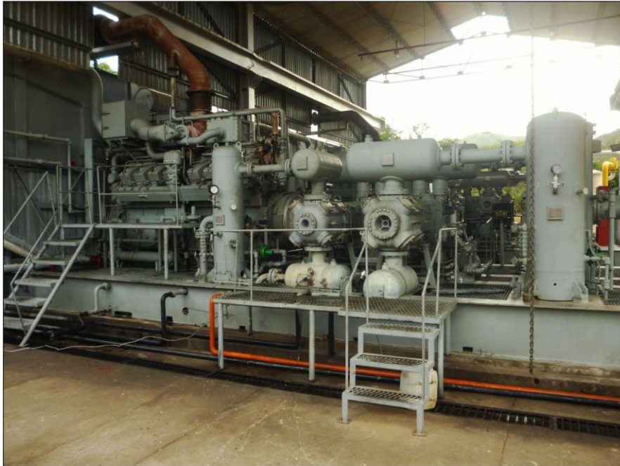
Fotografía 31. Área de compresores
