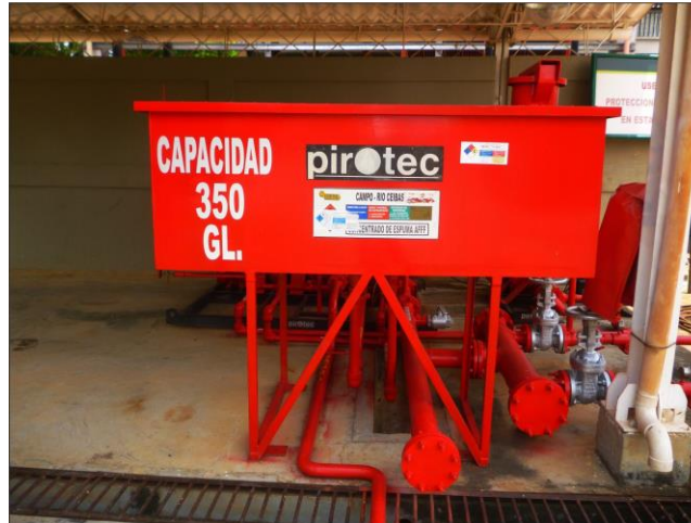
Fotografía 97. Tanque almacenador de concentrado espumante
