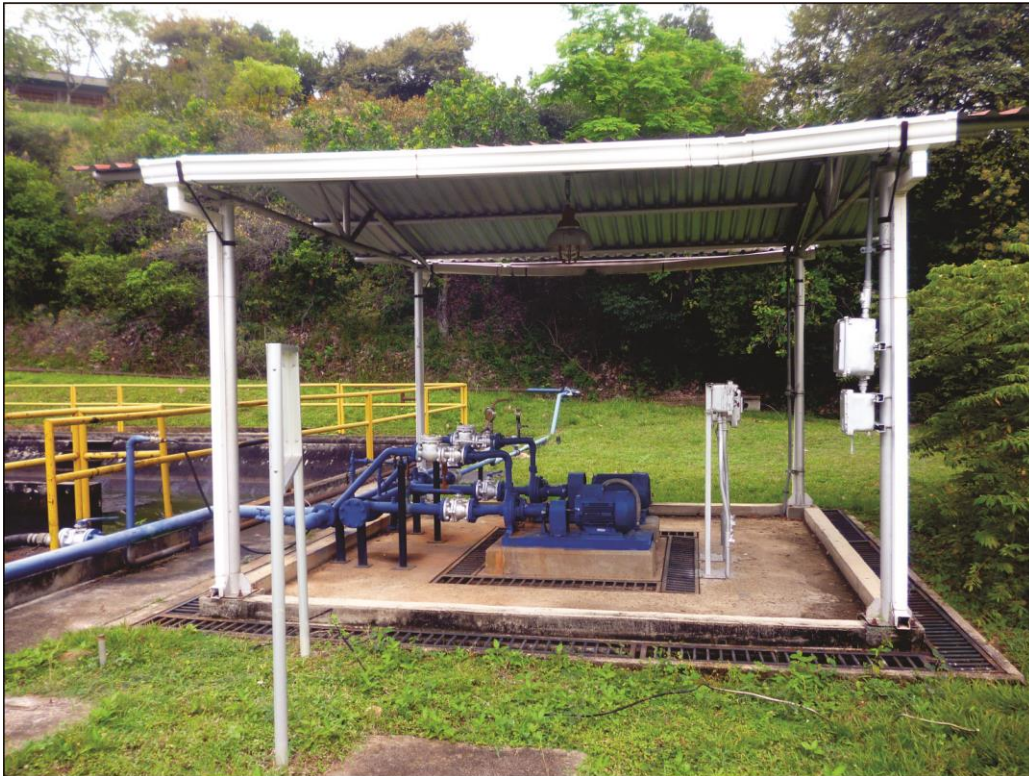
Fotografía 40. Bombas de recuperación de agua
