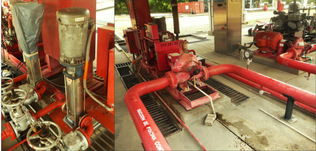
Fotografía 46. Bombas sustentadoras / bombas principales
