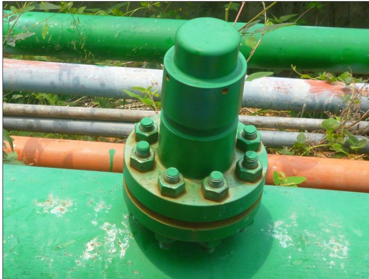
Fotografía 34. Cupón para monitoreo de corrosión
