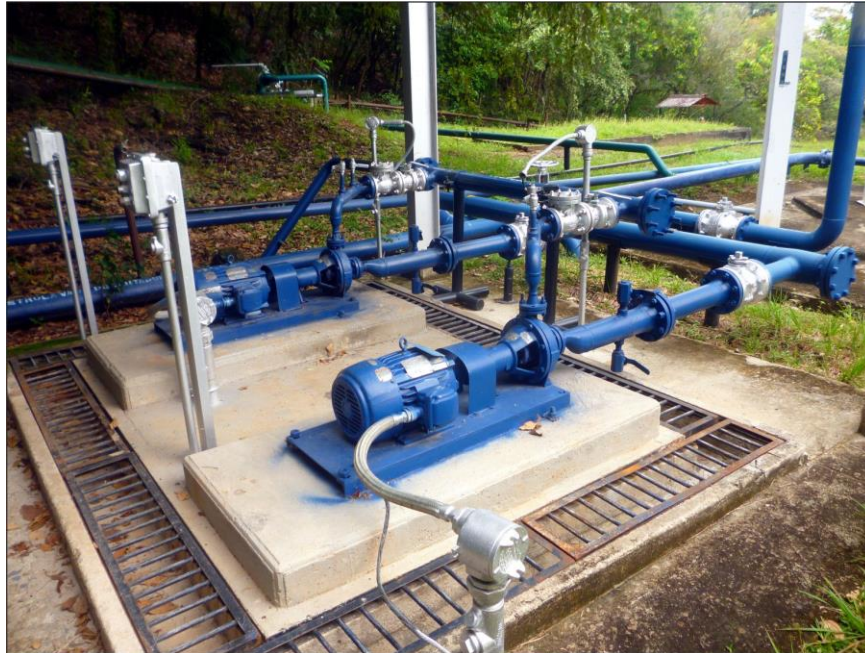
Fotografía 38. Bombas de recirculación del decantador
