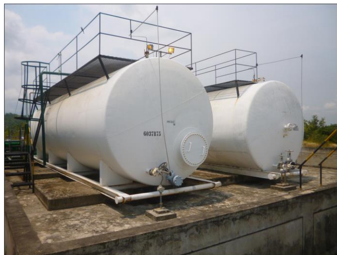
Fotografía 89. Tanques de cabeza
