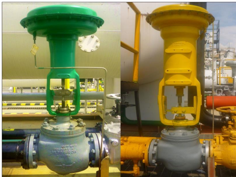
Fotografía 13. Válvulas en la salida de emulsión (LCV) y salida de gas (PCV)
