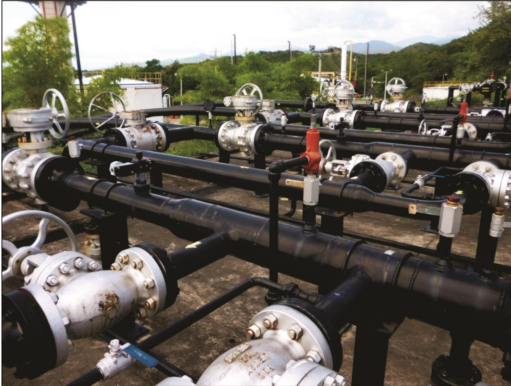
Fotografía 7. Trampas de recepción dentro de la estación
