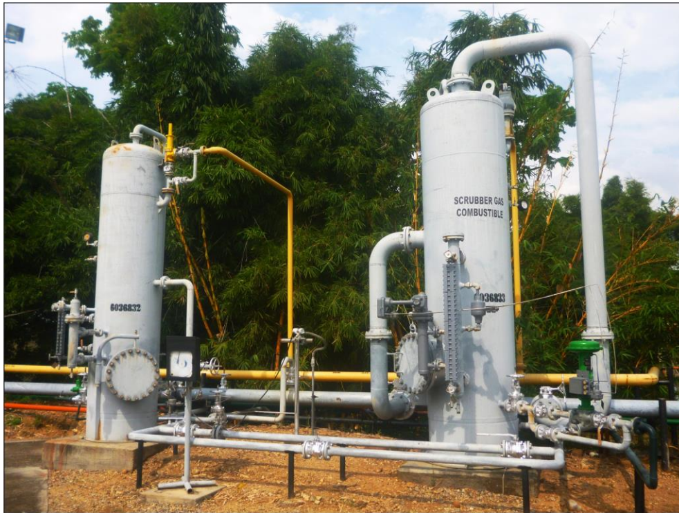
Fotografía 69. Área de scrubbers de consumo
