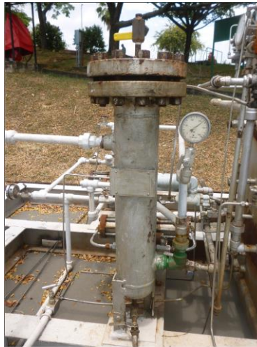
Fotografía 64. Filtro de alta presión
