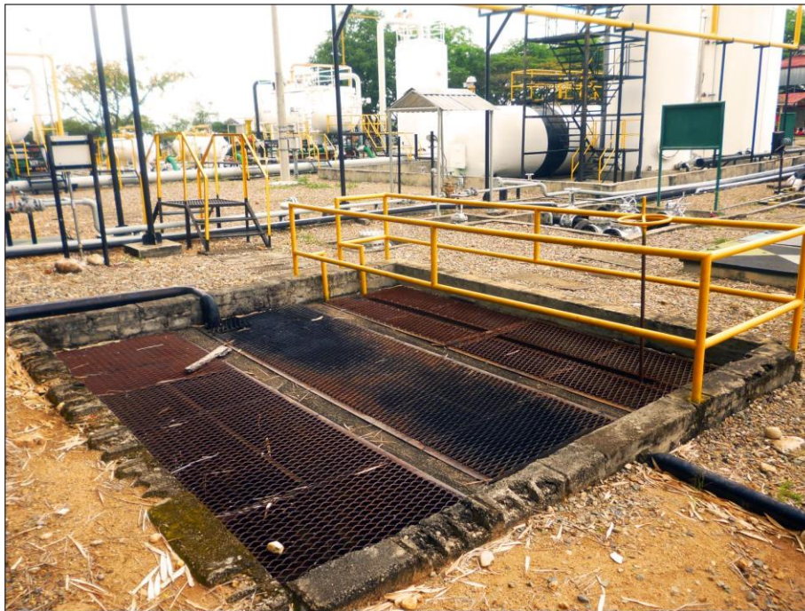
Fotografía 36. Caja de aceites y aguas lluvias
