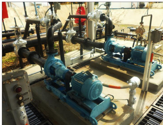
Fotografía 26. Bombas P-65-001-A y P-65-001-B
