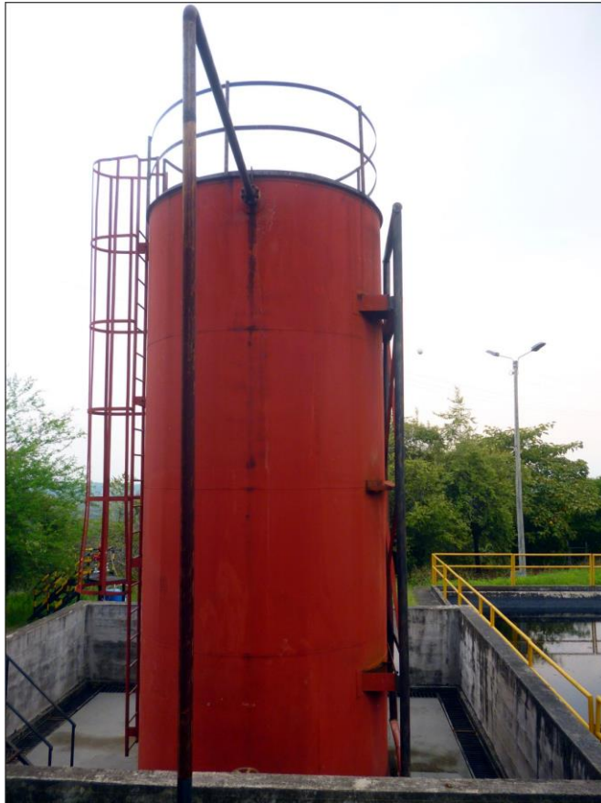
Fotografía 41. Tanque de borras
