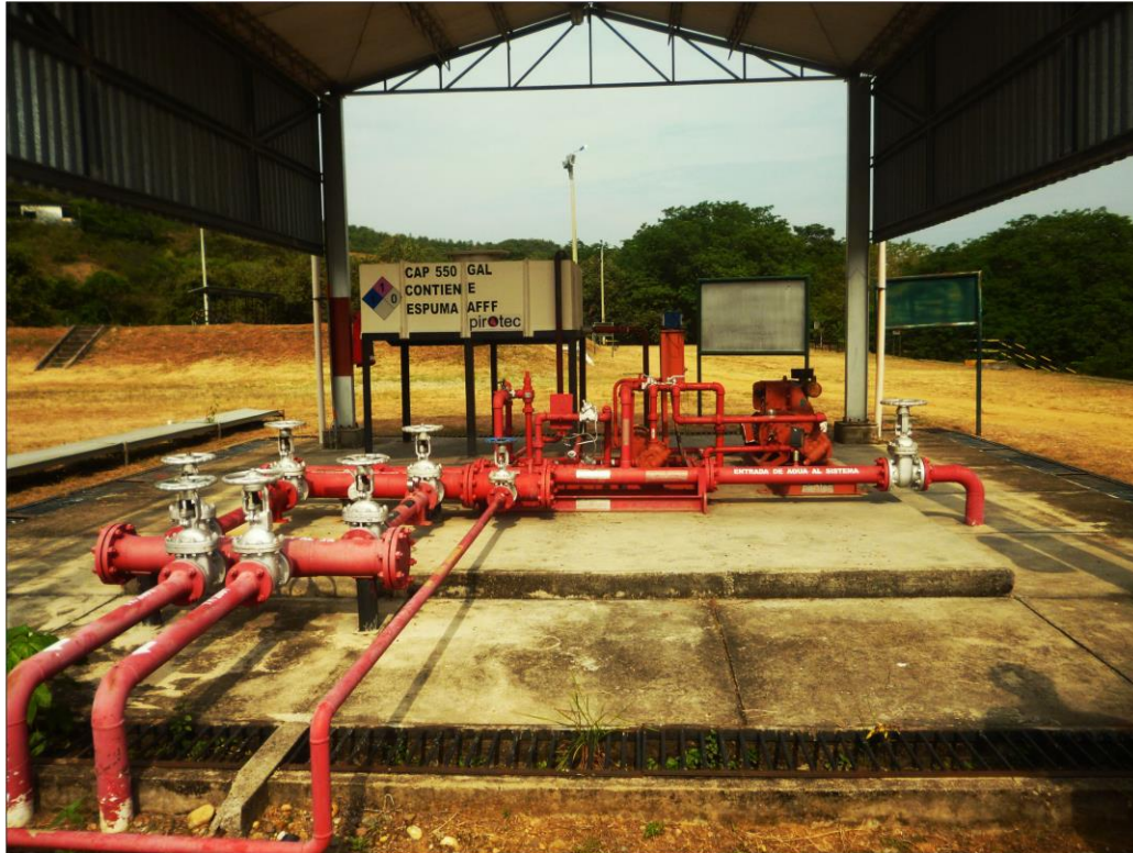
Fotografía 49. Caseta de generación de espuma
