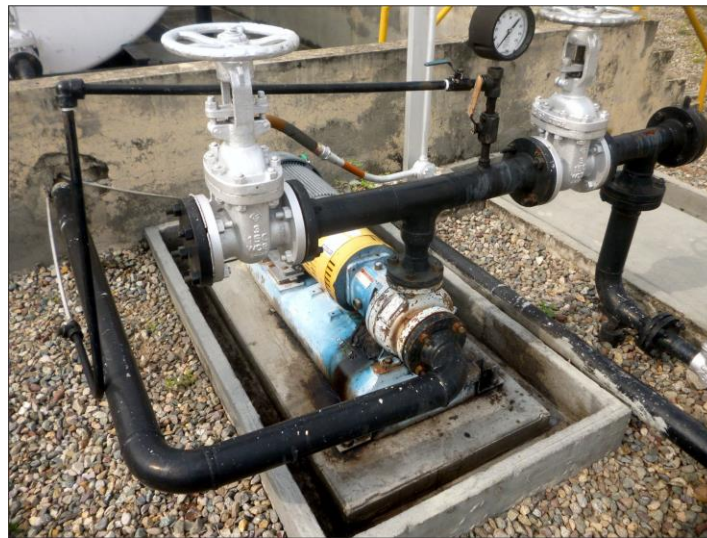
Fotografía 19. Bomba de circulación del sistema de prueba
