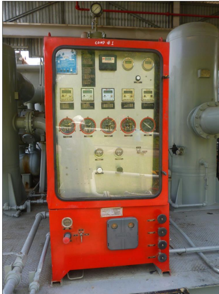
Fotografía 55. Panel de control (C1)
