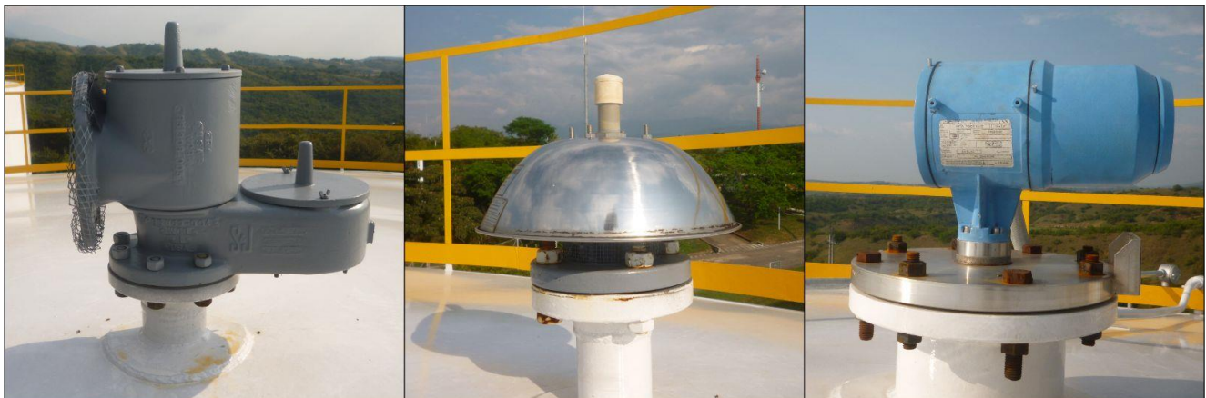
Fotografía 30. Válvula de presión y vacío, válvula de seguridad y transmisor de nivel
