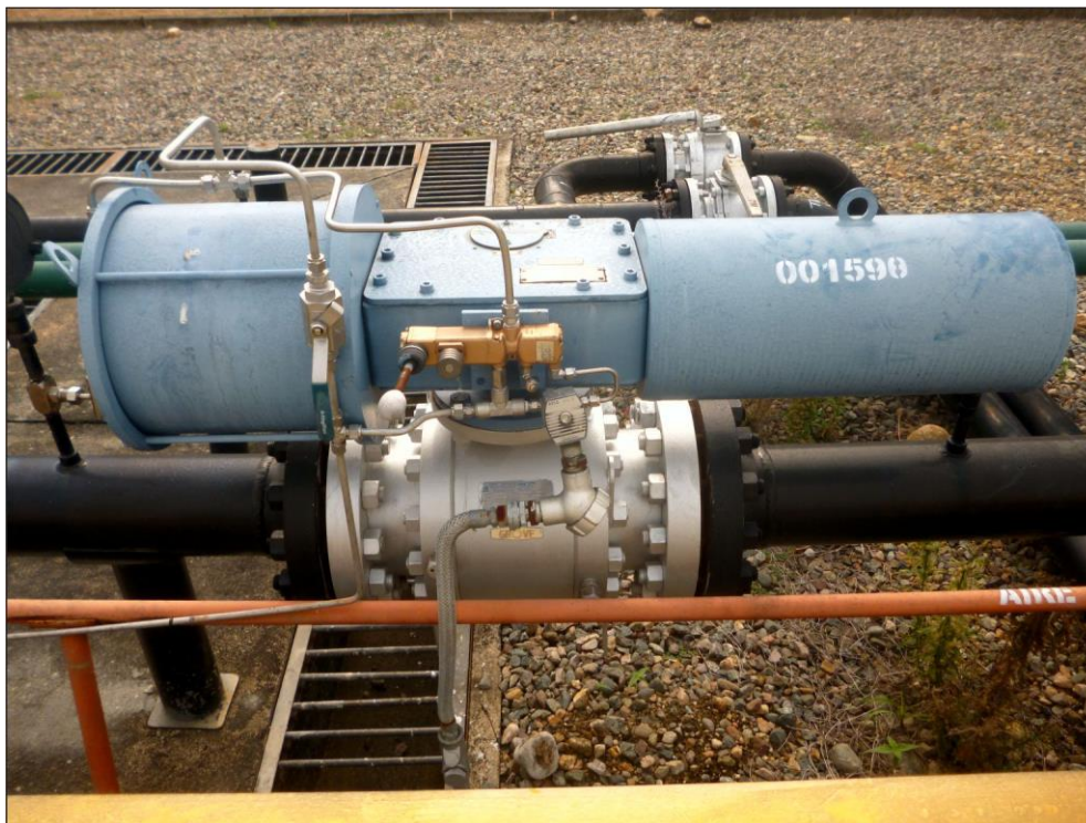
Fotografía 12. Válvula de Shutdown (ESDV)
