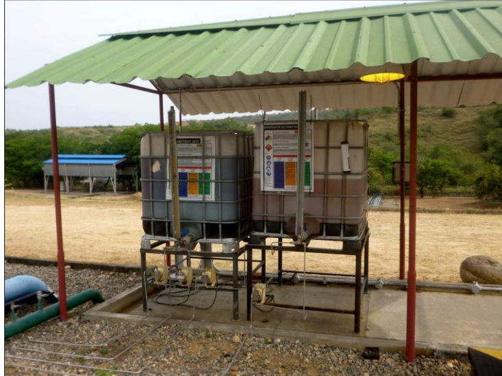
Fotografía 7. Caseta de inyección de químicos
