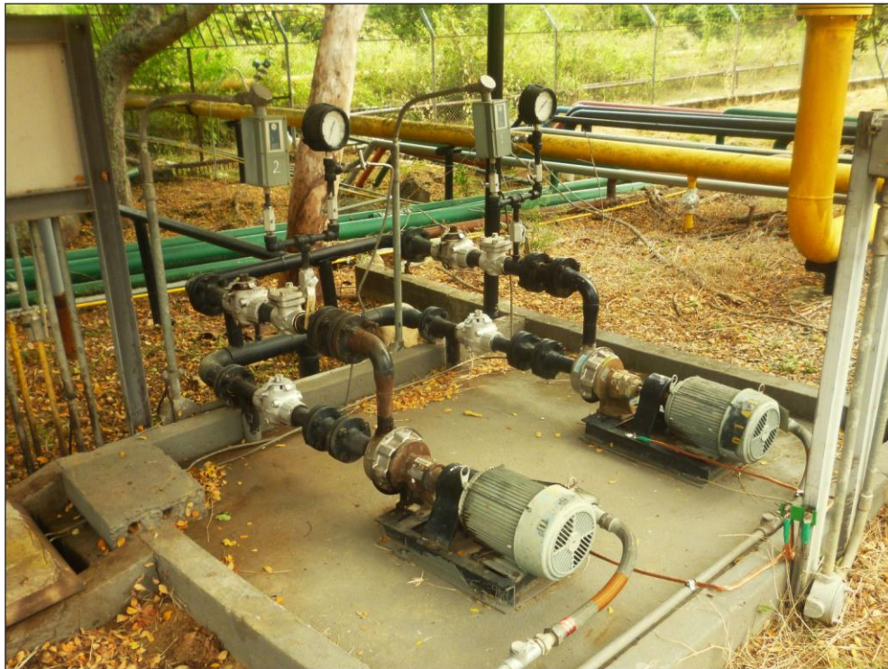
Fotografía 38. Bombas de drenaje del scrubber de la tea de alta
