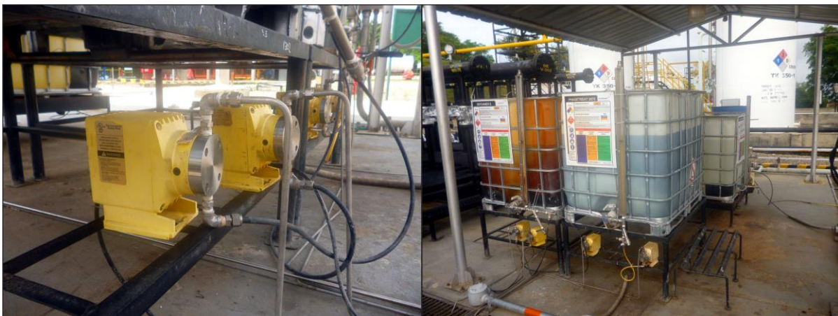
Fotografía 11. Bombas dosificadoras / Tanques almacenadores (bulk drum)
