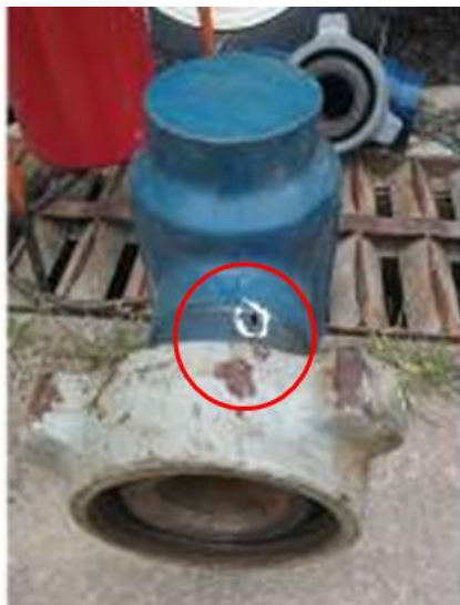
Figura 48. Pin hole en la target tee a la entrada del sand tank .
