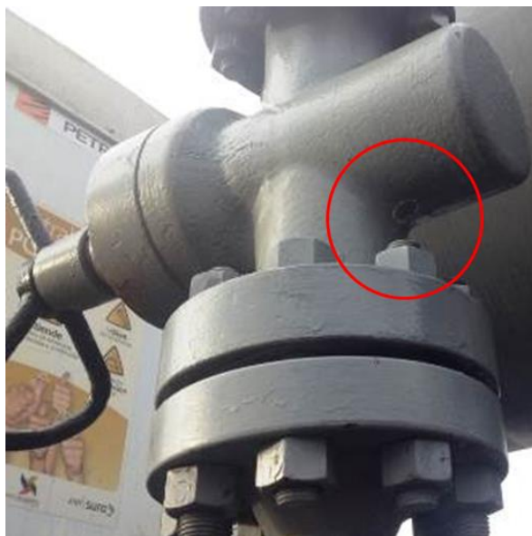
Figura 49. Pin hole en la válvula Wenlen de la línea de gas a la salida del separador de arena
