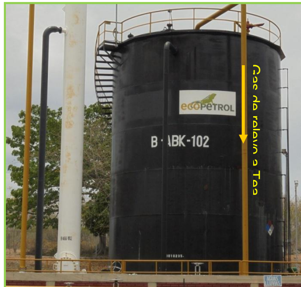
Figura 32. Salida de gas gun barrel B-ABK 102 Batería Balcón
