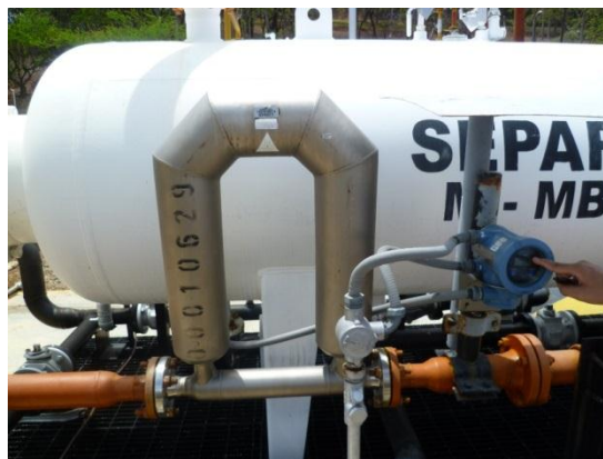
Figura 17. Medidor tipo coriolis de gas separador de prueba, batería Monal
