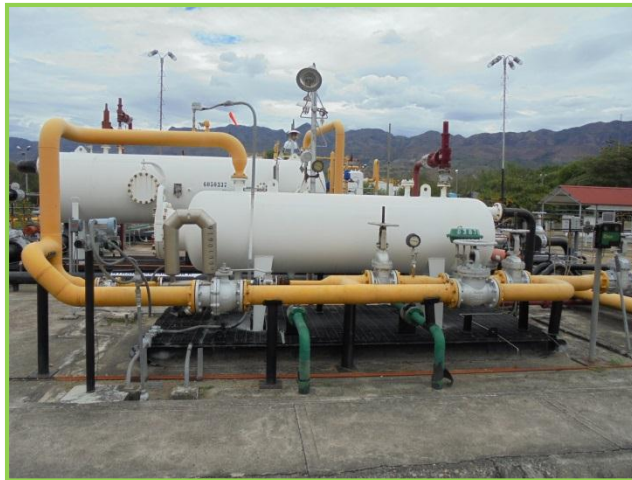
Figura 15. Separador B-MBD-103 (Fuente: Ecopetrol S.A)
