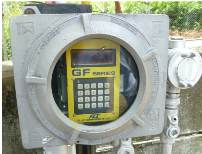
Figura 19. Medidor térmico en TEA, batería Monal
