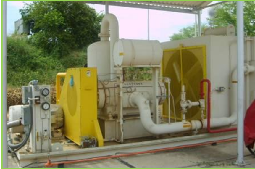
Figura 16. Compresor de anulares Balcón. (Fuente: ECOPETROL S.A.)
