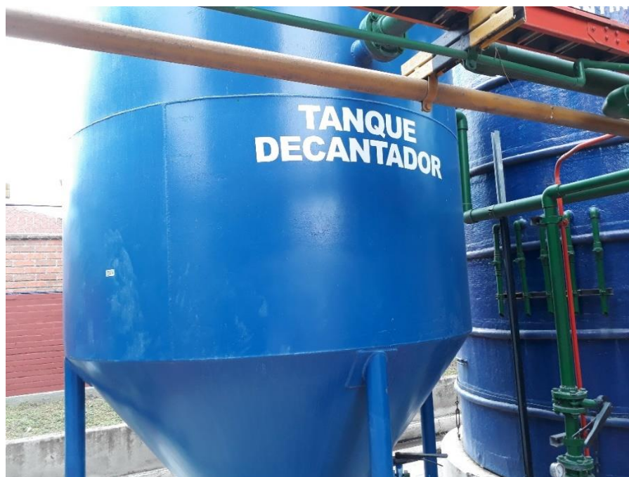
Fotografía 1 Tanque decantador de agua
