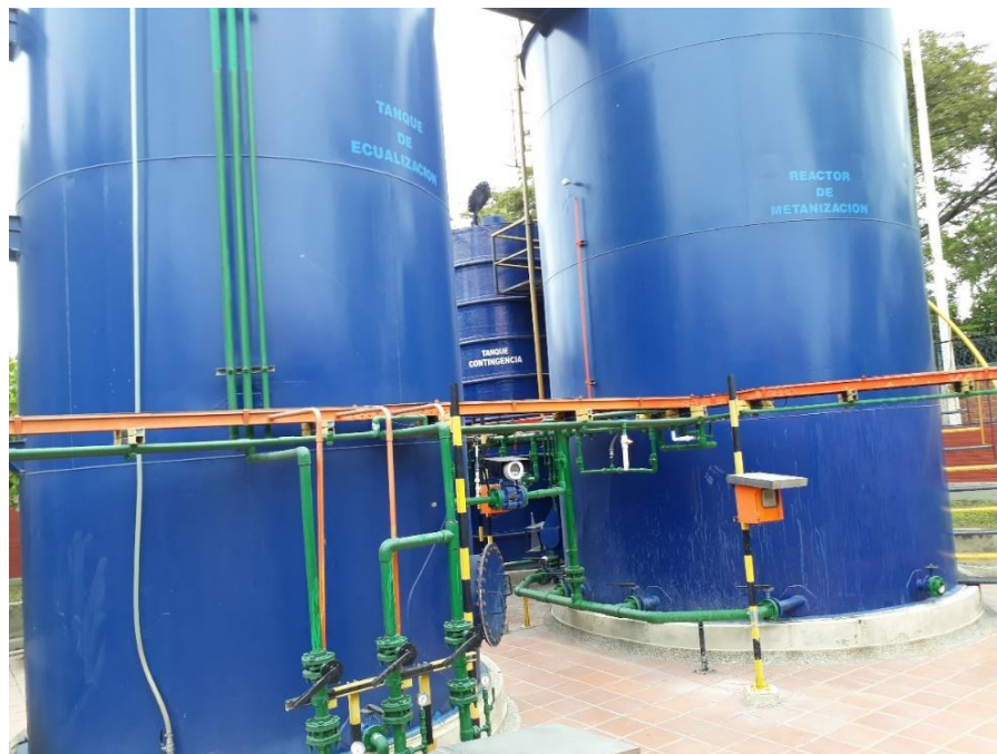
Fotografía 3 Tanque de Ecuación y Metanización
