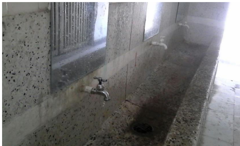
Figura 12. Desperdicio de agua
