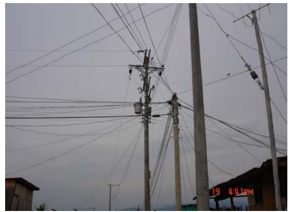
asentamiento Álvaro Uribe Vélez toma de la energía eléctrica año 2007
