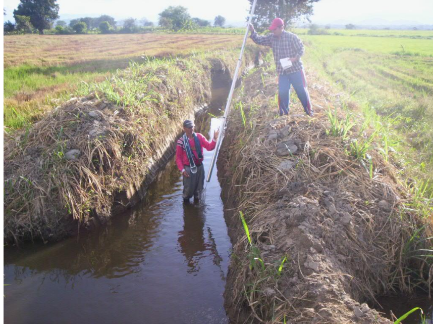
Foto 9. ) Vista General del sitio proyectado para Toma Predial sobre el Canal La Sanchez (predio de Sandra Edilia Tovar)
