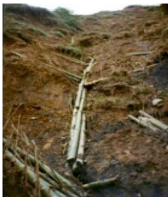
Figura 6. Filtros en espina de pescado hechos con guadua y nacedero
