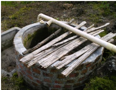
Figura 27. Desnatador y Filtro Finca: La Fortuna
