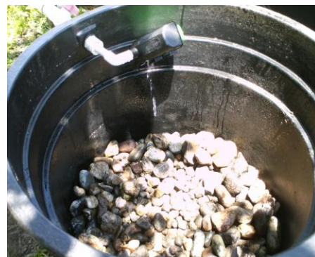
Figura 25. Recamara de Dosificación RD (STMA 180) Finca: Villa Linda
