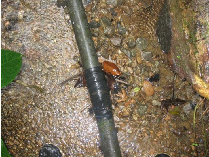
Figura No. 5. Deterioro manguera de polietileno
