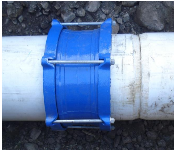
Foto N°1. Unión Dresser - Dresser de 14''
