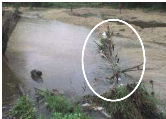
Foto 15. Captación Tipo Fusible.
