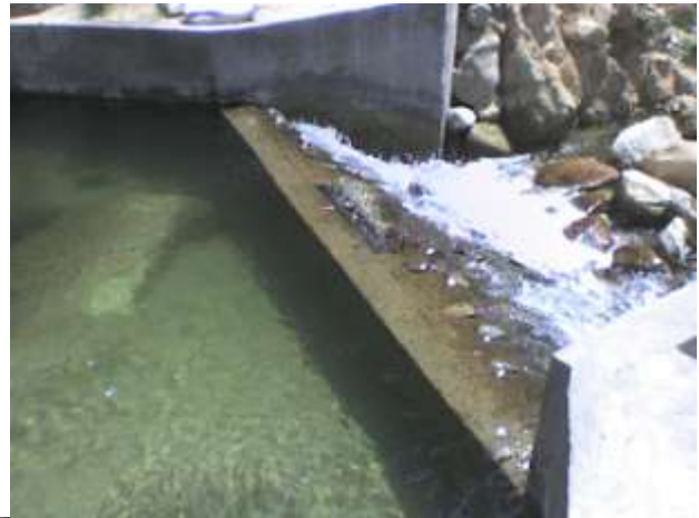
Foto 24. Bocatoma Rejilla de fondo Acueducto vereda Bajo Piravante
