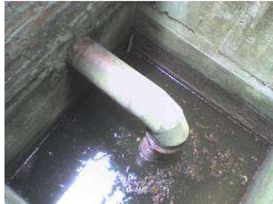
Foto 19. Tubería de Captación 6"
