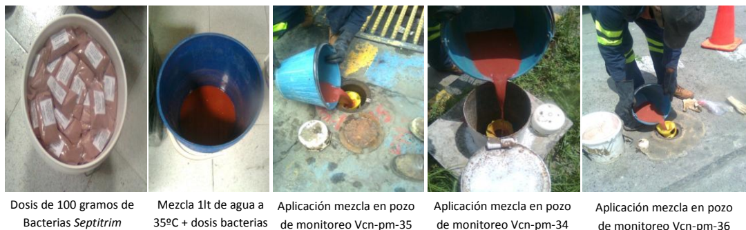
Figura 37. Procedimiento aplicación de bacterias en pozos de monitoreo
