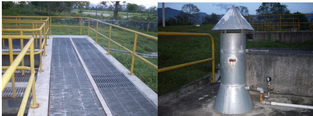
Figura 38: Pasamanos y válvulas que presentan corrosión
