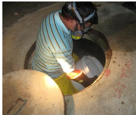
Figura 28: Medición de caudal en la PTAR
