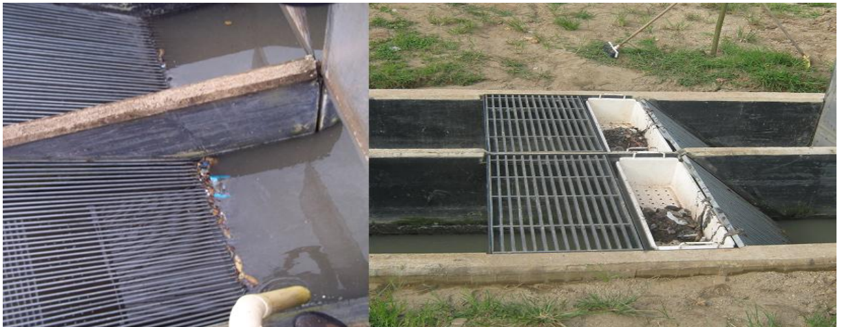
Figura 9: Rejas de cribado. Canastas de recepción y escurrimiento
