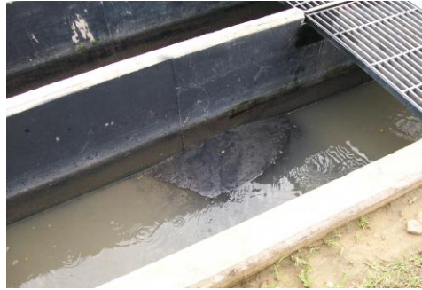
Figura 37: Desarenadores colmatados de material
