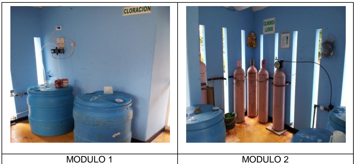
Foto No.8 Sistema de cloración.
