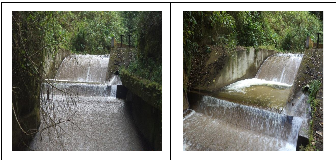
Foto No. 1 Bocatoma municipal.
