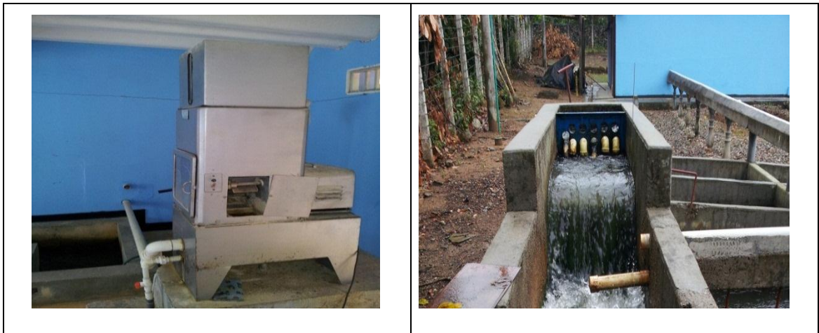
Foto No.5 Dosificador de Sulfato y Vertedero Rectangular de Cresta Delgada Modulo No.2.
