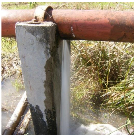
Fotografía 9. Escape de caudal por una fisura en la tubería.
