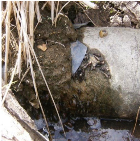
Fotografía 3. Escape de caudal por una fisura en la tubería de aducción.
