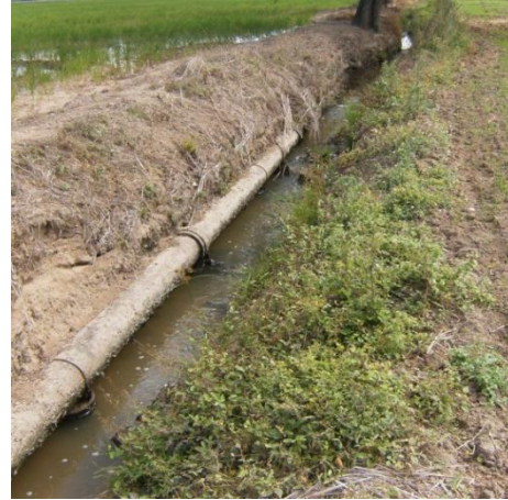
Fotografía 2. Tubería de aducción expuesta a la intemperie.
