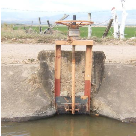
Fotografía 1. Compuerta de control salida caudal del canal C4 hacia la granja.
