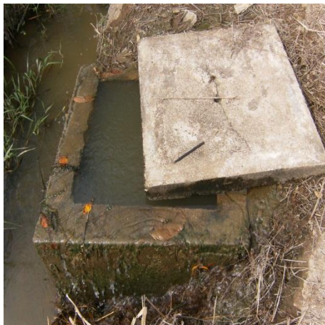
Fotografía 7. Cajilla 7 anteriormente obstruida.
