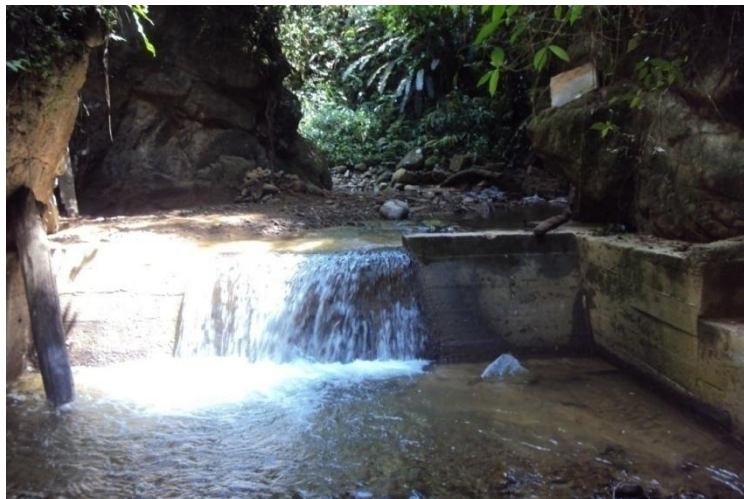
Figura 17. Bocatoma minidistrito de riego Asocabaña
