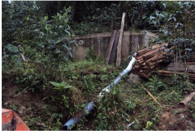
Figura 26. Deterioro obras hidráulicas minidistrito de riego Asocabaña
