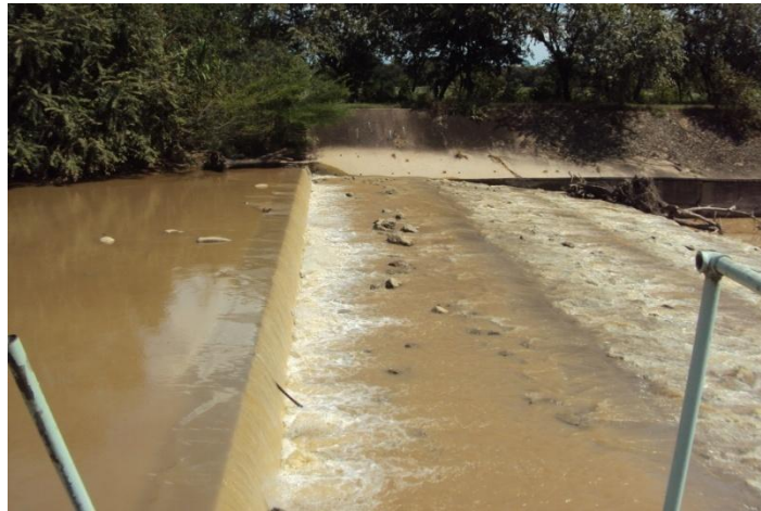
Figura 9. Bocatoma Rio Villavieja distrito de riego Asoporvenir
