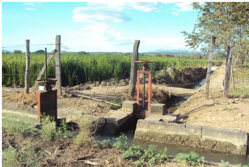
Figura 25. Suministro de agua distrito de riego Asoporvenir
