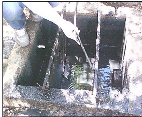
Lavado de rejillas
