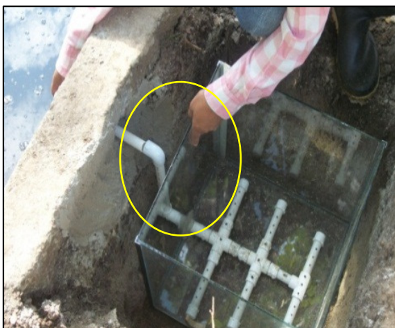
Conexión con el tratamiento primario y zona de entrada al filtro
