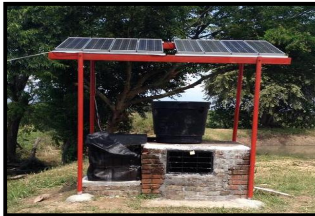
Ilustración 33. Instalación sistema de fertirriego
