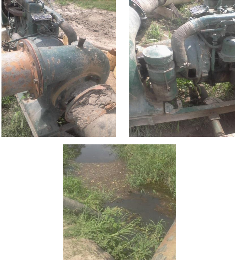
Figura 50. Hidrobomba motor ZETOR serie 83002 y cárcamo de succión caño Uvito. Plantación el Castillo 2014
