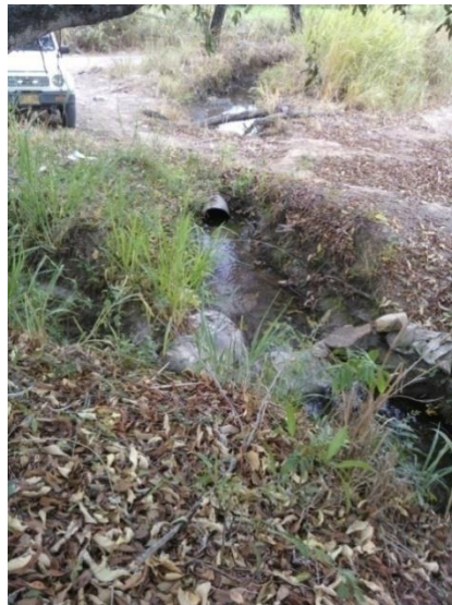
Vegetación obstruyendo el flujo del agua
