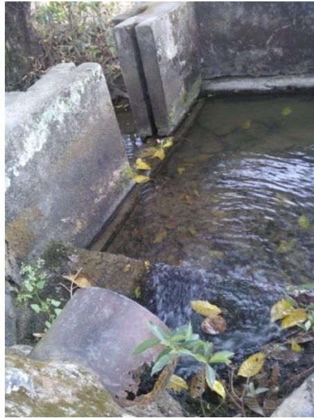
Instalaciones de medición de flujo obsoletas
