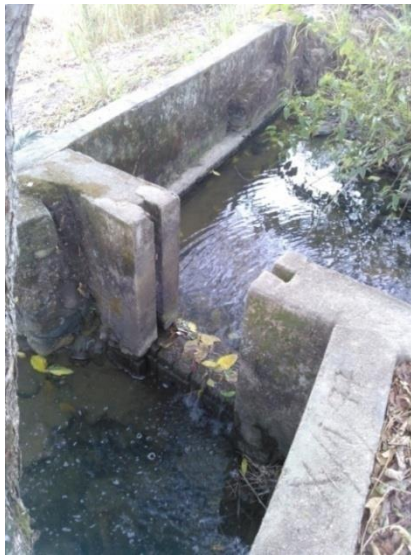
Instalaciones de medición de flujo obsoletas
