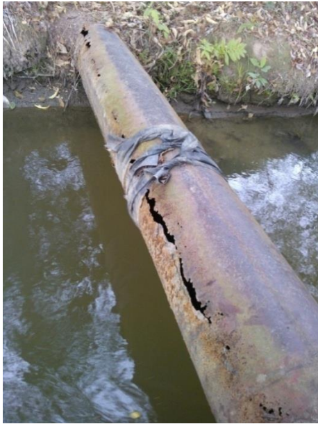
Tubería corroída y en mal estado
